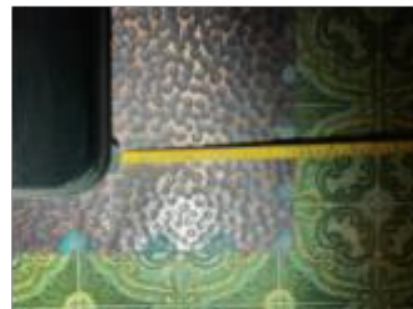
Ildfast plate foran ildstedet er for liten.
