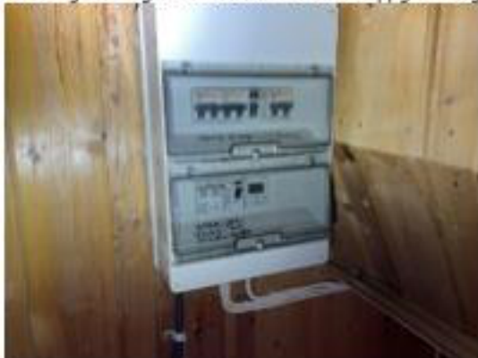
Enkel sikringsboks med seriemåler.
