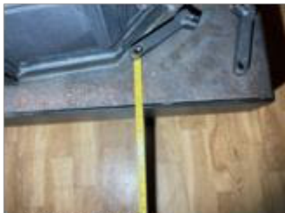
Ildfast plate foran ildstedet er for liten.
