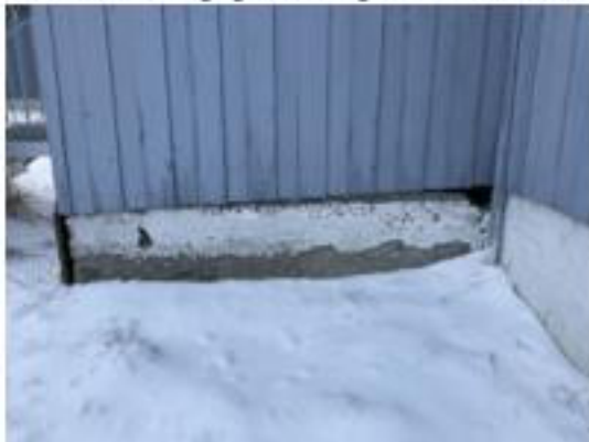
Gangen har sunket og det gliper over muren.
