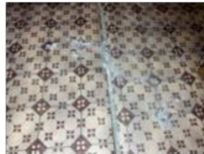
Sprekk i løst belegg, saltutslag fra betonggolvet.
