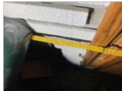
Røykrør for nært brennbart.
