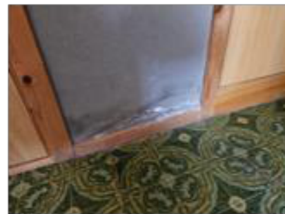
Avskalling ved golvet.
