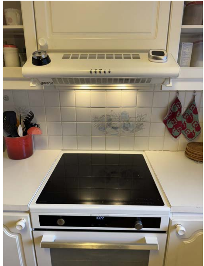
Avtrekksvifte montert over komfyren.
