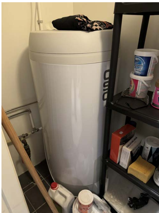
Varmt vanns bereder.
