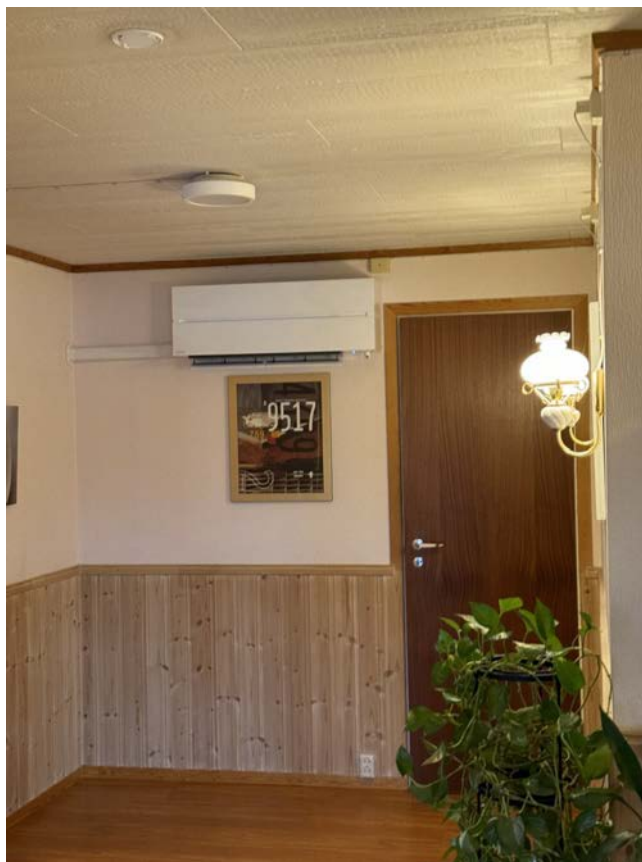
Varmepumpe i hall i 1. etasje.
