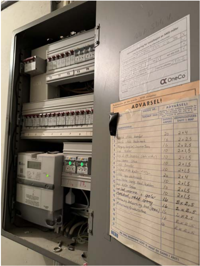
Sikringsskap med automatsikringer og kurs fortegnelse plassert i nedgangen til kjeller.
