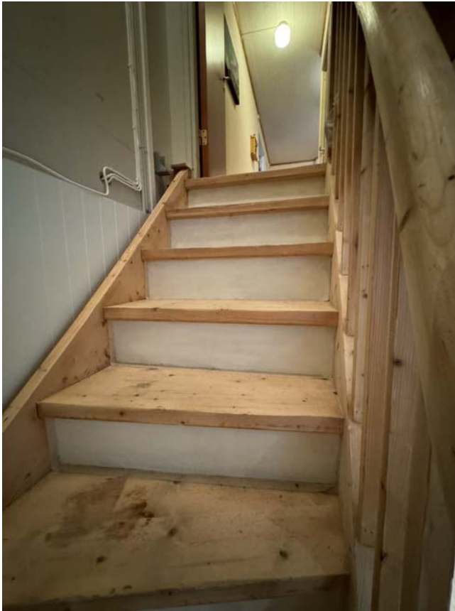
Lukket tre trapp fra 1. etasje og ned til kjeller.
