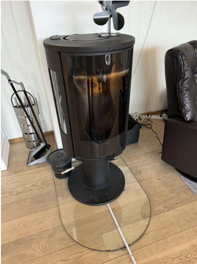
Ovn for fast brensel montert i stuen på ei glass plate som strekker seg 35 cm framfor ildstedet.
