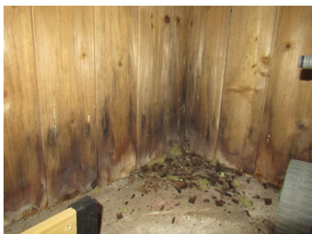
Fuktskader i kjeller etter vann inn.
