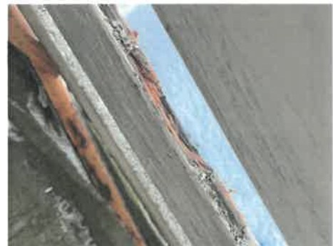
Råte i rekkverksbord
