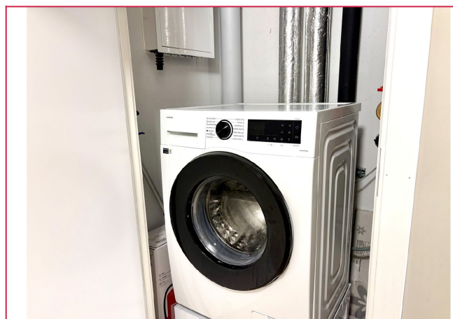
Teknisk rom med opplegg for vaskemaskin
