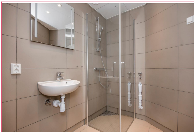
Bad - varme i gulv.
