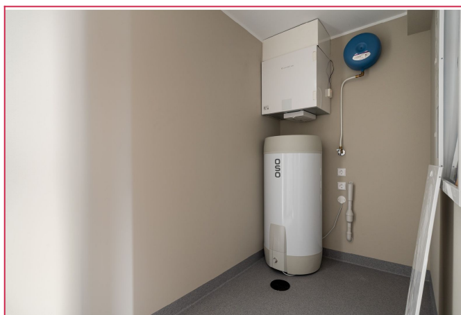
Teknisk rom, balansert ventilasjon og egen varmtvannsbereder.
