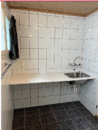
Flislagt bad med vaskemaskin og tørketrommel
