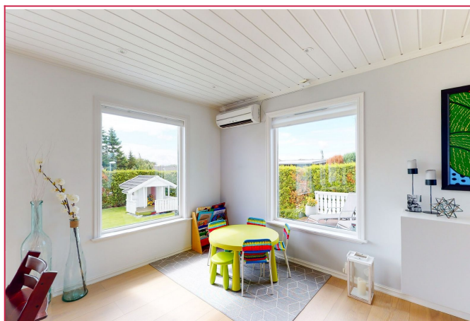
Stue - det er montert varmepumpe
