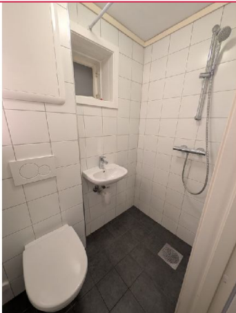
Bad med toalett, dusj og servant.
