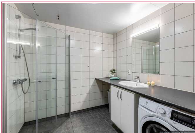
Varmekabler i gulv
