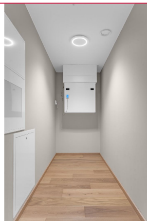
Teknisk rom / innvendig bod
