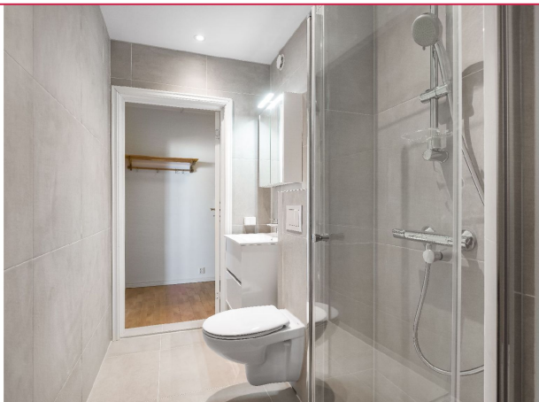
Nyere flislagt bad fra 2021.
