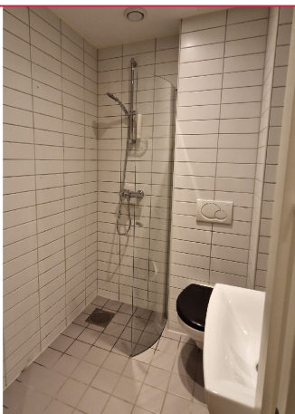
Flott bad med varmekabler i gulv.
