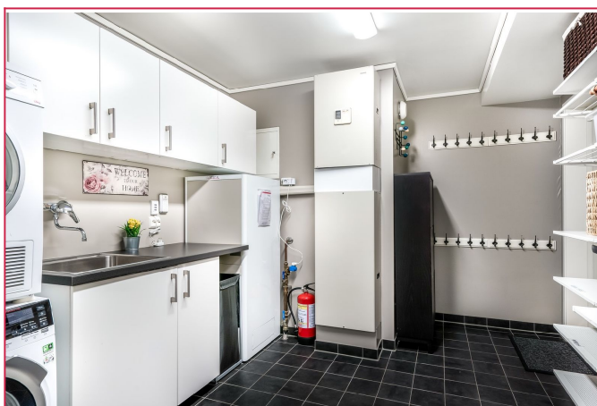
Vaskerom/teknisk rom i 1.etg, med direkte adkomst fra garasje.
