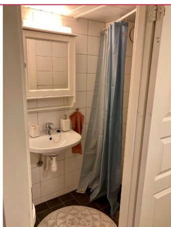
Baderom med varmekabler.
