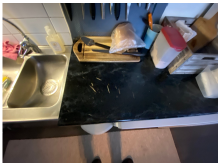
Hakk/skader i benkeplate
