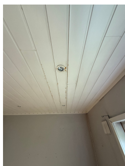
Vann gjennomtrenging i himling
