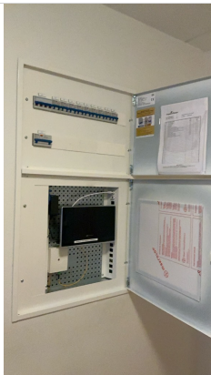
Sikringskap med automatsikringer
