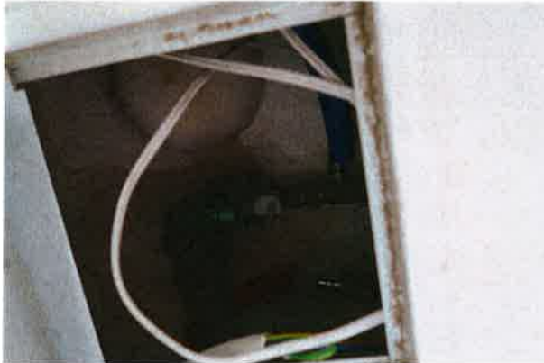
Luke i taket med hovedstoppekran
