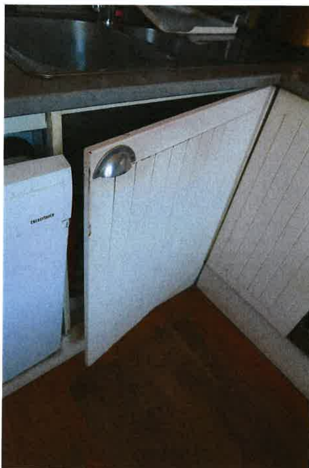
Skapdør henger og har skader i malingen.
