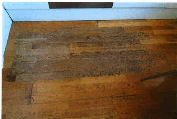
Parkettgulv ved kjøkkenbenk har stor slitasje
