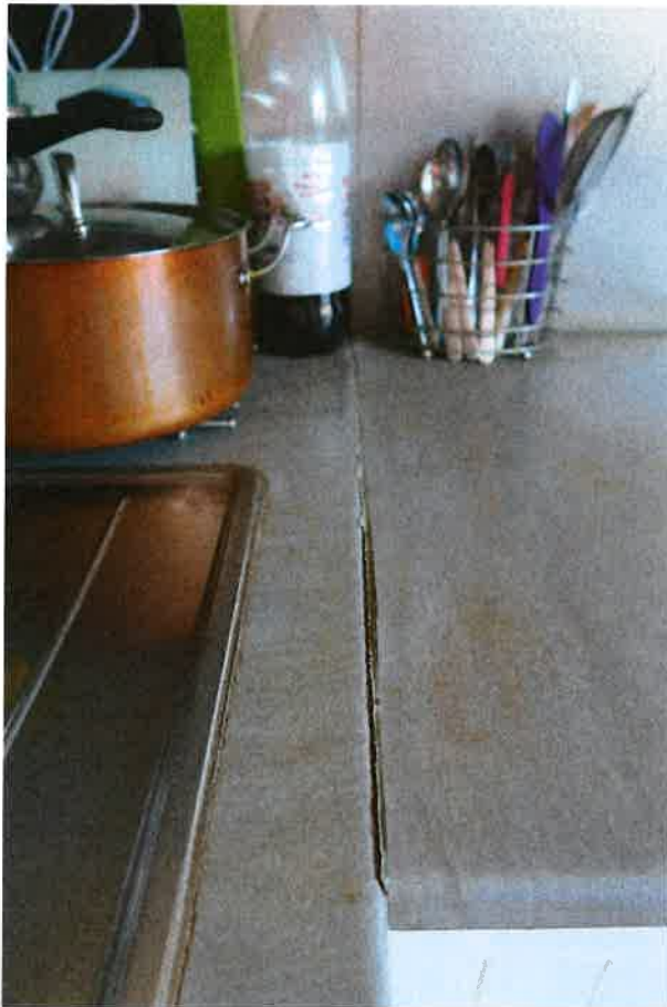
Benkeplater har svellinger i skjøte
