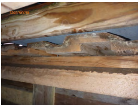
Manglende smådyrsperre under altan mot sørvest.
