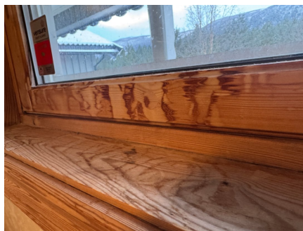
Fuktskjolder på ramme, vaskerom
