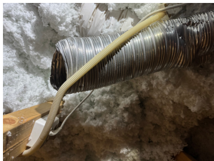
Ødelagt kanal på loftet
