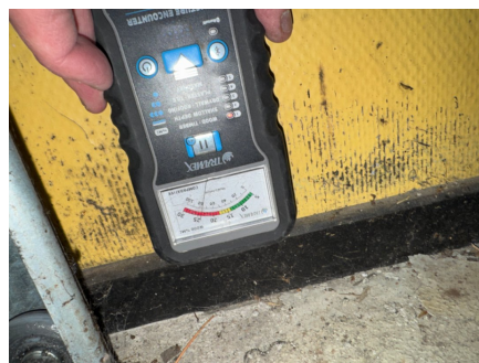
Fuktopptrekk i oppkant i garasje
