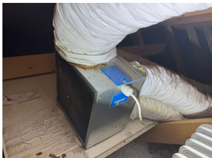
Ventilasjonsanlegget på loftet
