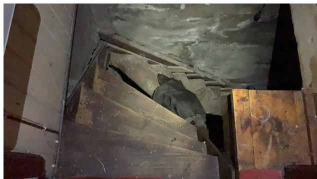
Store skader på kjellertrapp der trinn, rekkverk og håndløper mangler. Samt registrert fuktpåkjønning i endevend mot kjeller
