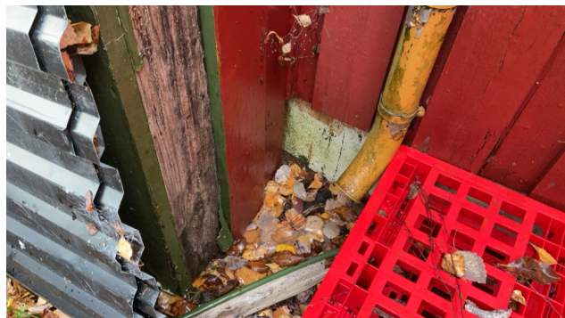
Manglende bortledning av takvann
