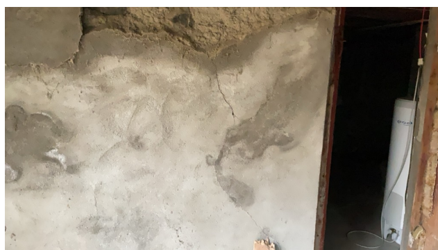
Sprekker i mur
