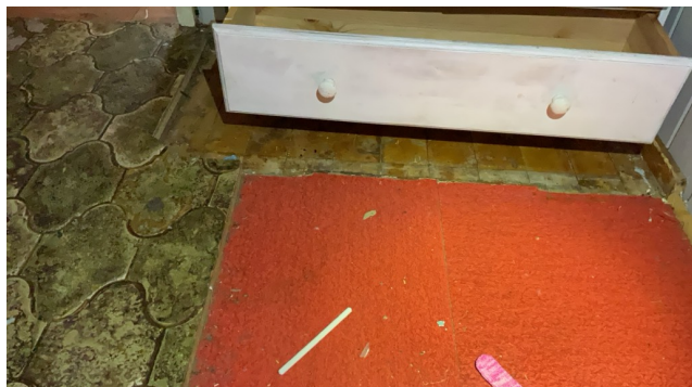
Hull og åpning av gulv
