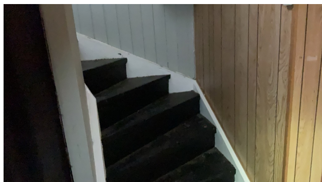
Slitasje på trapp, manglende håndløper
