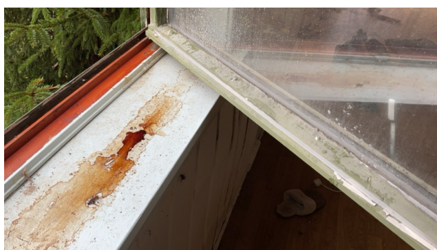
Utvendig slitasje og merker av fukt og gris innvendig
