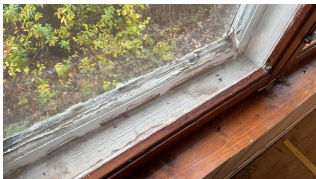
Vinduer må skiftes
