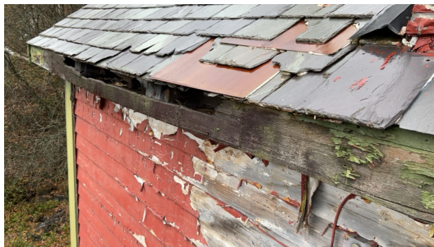
Råteskader i takkonstruksjonen
