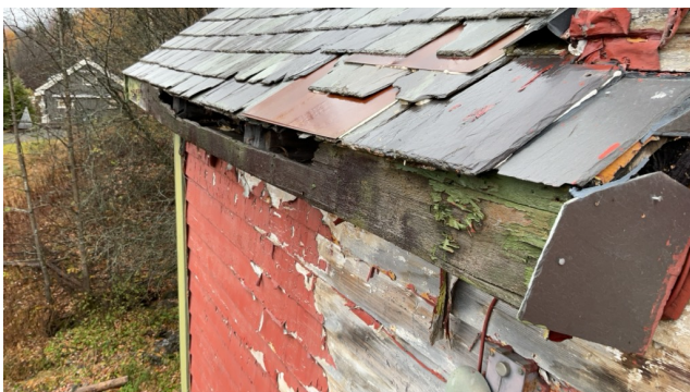
Ikke montert takrenne eller forkantbeslag, råteskader i takfot
