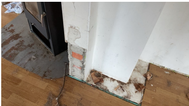
Skade på endemur
