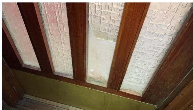
Knust glass og slitasje på hoveddøren, må påregnes utskifting
