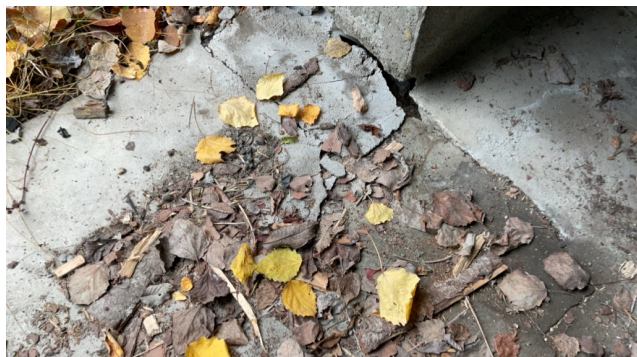
Setningsskader i kjellergulv
