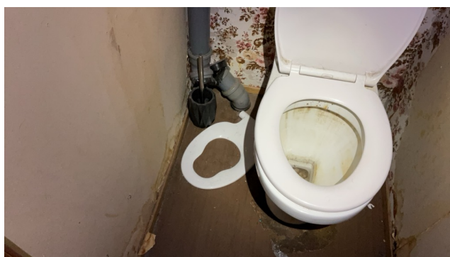
Slitasje på klosett
