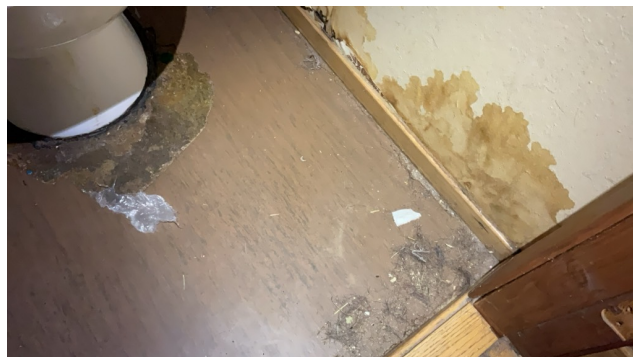
Skade på gulv og veggoverflater, fuktskjolder i overgang gulv/vegg
