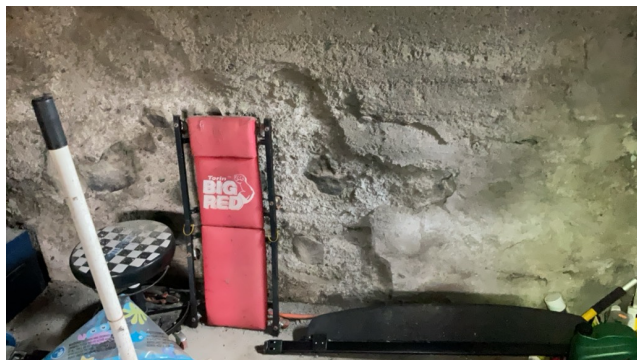
Forvitring og løs betong gjør tiltaksbehov nødvendig
