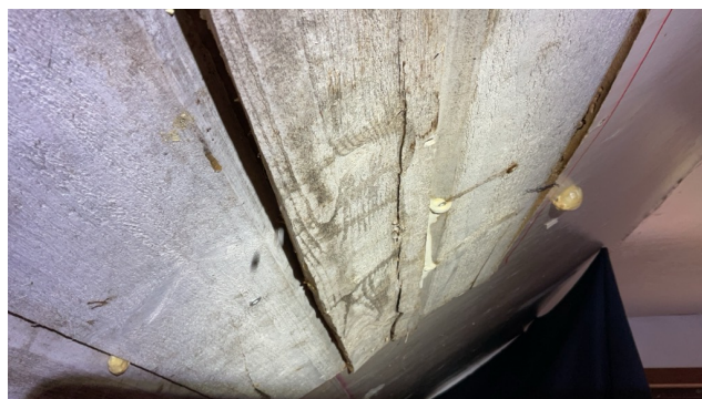
Lekkasje fra tak
