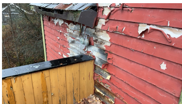
Skader på fasade
