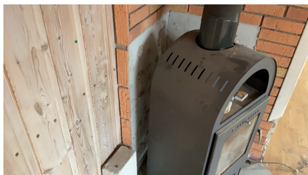
Avstad fra ovn til brennbart materiale er for kort og brannmur bør forlenges
