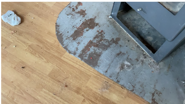
Slitasje på plate under gulv og avstand til brennbart materiale på gulv er for kort da plate er for liten
