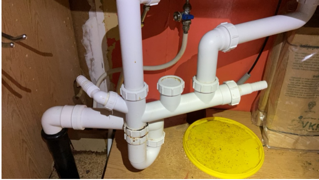
Avløpstilkoblinger bør blendes, fare for lekkasje
