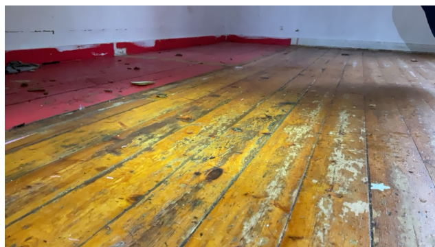
Vann på gulv i 2. etasje
