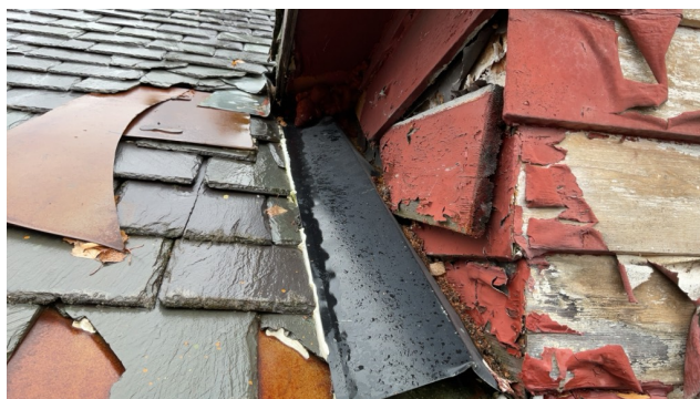
Ikke egnet overganger
