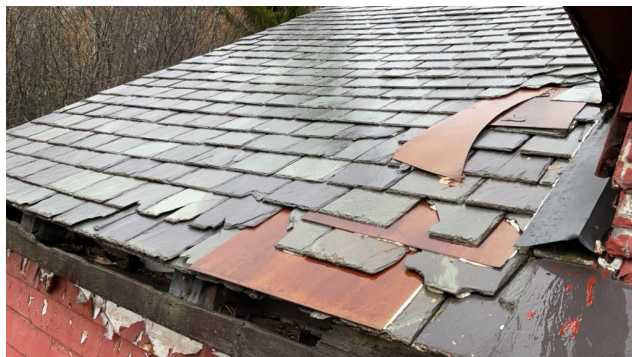
Skader på tekking med synlig utettheter
