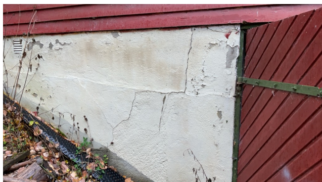
Sprekker i mur
