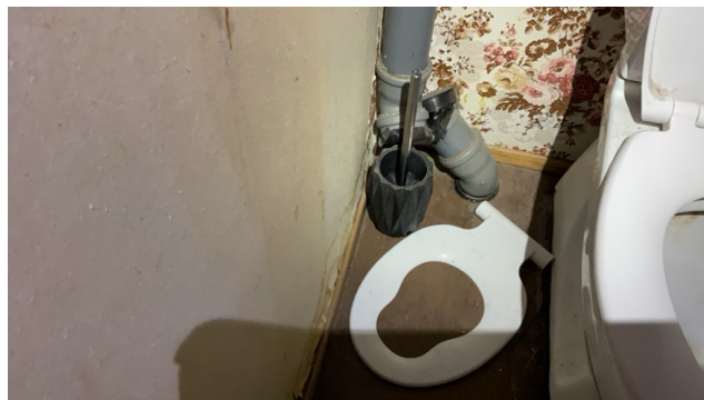
Lufting på avløp er fjernet og ufagmessighet.
