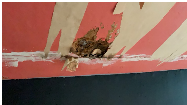
Fukt og rådeskader
