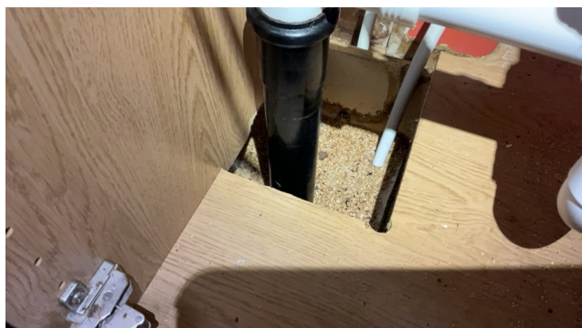
Stedvi åpninger mot etasjeskille, synlig flisfylling og aktivitet av skadedyr
