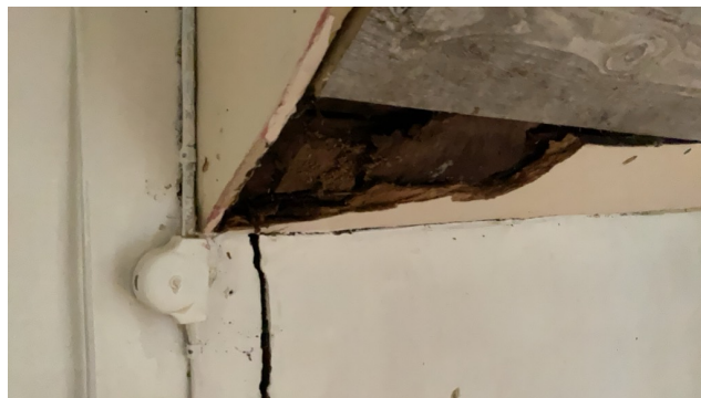
Fukt og råteskader
