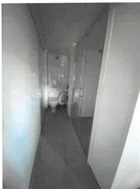
Gulvmontert toalett, dusj og opplegg for vaskemaskin.
