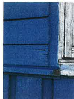
Utvendig kledning er værslitt og har tørkesprekker, råte stedvis registrert.
