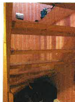
Åpninger under trinn på over foreskrevne 10 cm.
