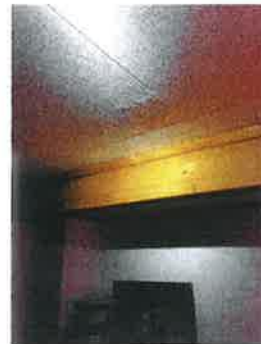
Fuktskader i himling i kjellerstuen.
