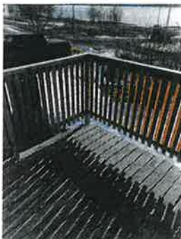
Oversiktsbilde. Rekkverket er nylig skiftet. Rekkverket er under foreskrevne 100 cm.
