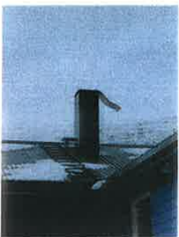
Løs del på pipebeslaget, må påregnes reparert.
