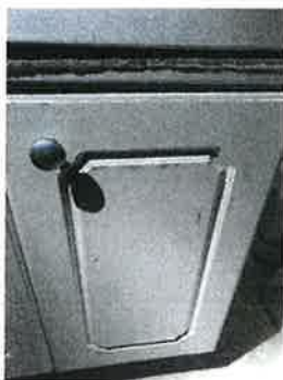
Fuktskader på baderomsinnredning.
