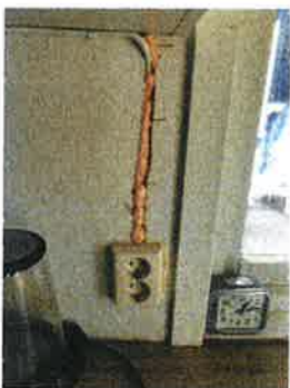
Ufagmessige elektriske arbeider, registrert.
