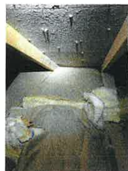
Bildet viser at det er mangelfull lufting ved raftene. Bildet viser også at det er soppdannelser under taktroa.
