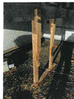
Veranda i front er stedvis provisorisk understøttet.
