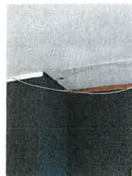
Gamle fuktmerker i himling i stuen i hovedetg.
