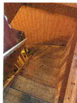
Bruksmerker og manglende håndlist på vegg.
