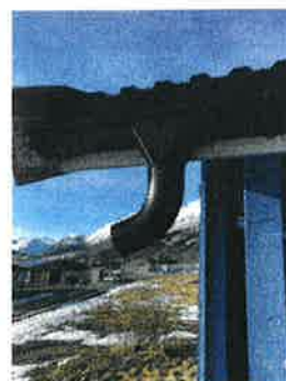
Det mangler stedvis nedløpsrør.
