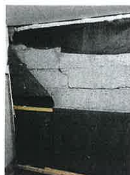
Innvendig utforet trevegg er åpnet etter vannskade. Sprekke i mur registrert.
