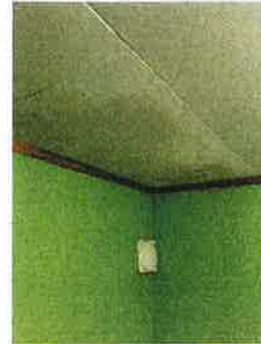
Fuktskader i himling i kjeller (vaskerom).
