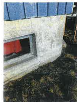
Malingen er stedvis avflasket. Ny overflatebehandling må påregnes.
