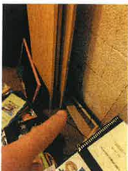
Bildet viser sotluken med brennbare materialer på gulv under.
