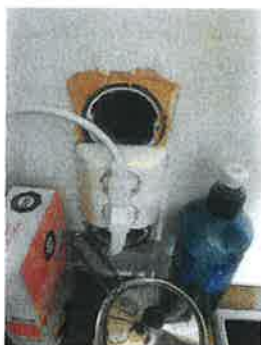
Ufagmessige elektriske arbeider, registrert.
