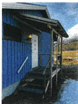
Trapp ved hovedinngang, er underdimensjonert og påvirket av telespreng.
