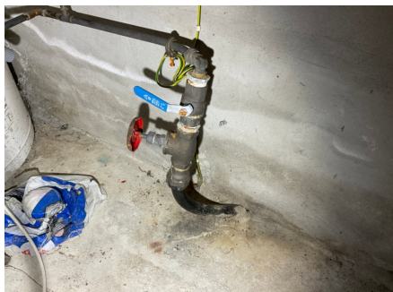
Vanninntak i PE(plastledning) og stoppekran i kjeller.
