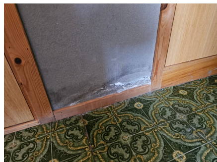
Avskalling ved golvet.
