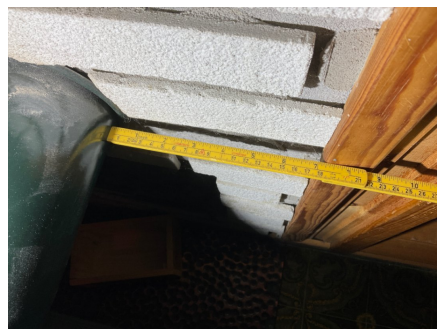
Røykrør for nært brennbart.
