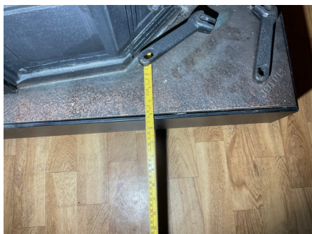
Ildfast plate foran ildstedet er for liten.
