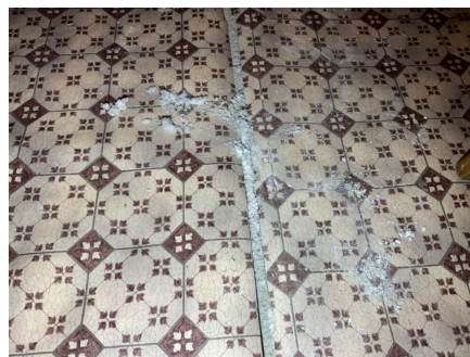
Sprekk i løst belegg, saltutslag fra betonggolvet.
