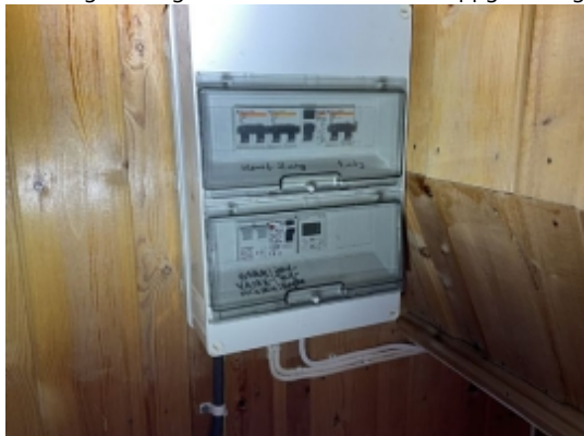
Enkel sikringsboks med seriemåler.
