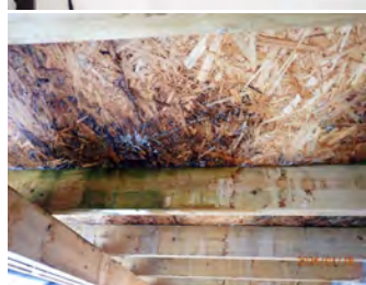
Våte flekker under terrasse på OSB-plater.
