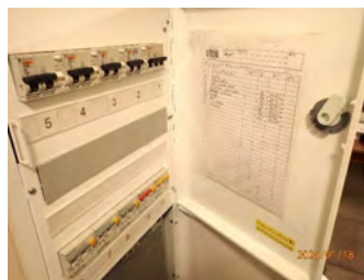
Type el. fordelingstavle/sikringsskap som er i boenhetene.
