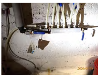
Stoppekran for vann i kjeller.
