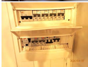
Type el. fordelingstavle/sikringsskap som er i boenhetene.
