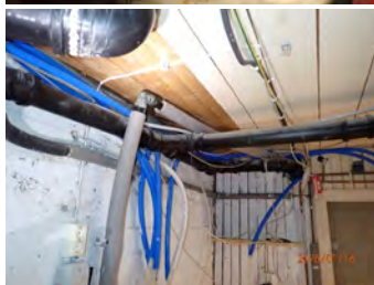
Avløpsrør og vannledninger i kjeller.
