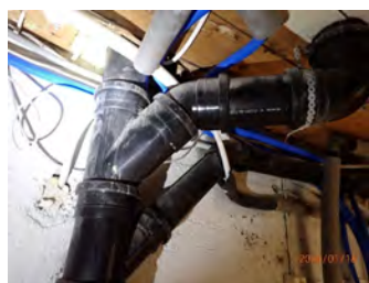
Åpne avløpsrør og vannledninger i kjeller.
