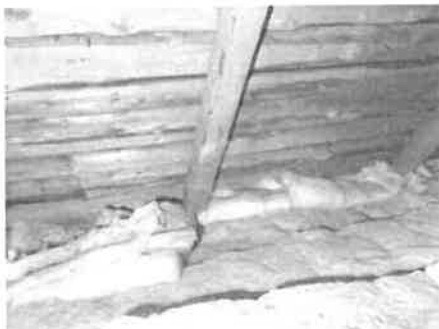
Manglende lufting av skråtak.
