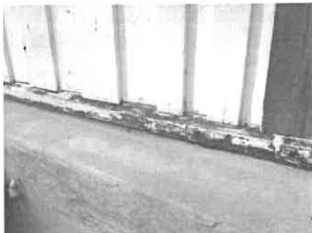
Manglende lufting med mot grunnmur.
