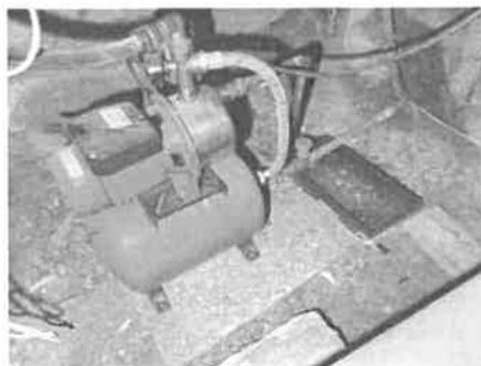
Pumpe med trykktank i kjelleren.
