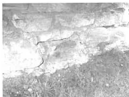
Sprekker i grunnmur på grunn av setninger.
