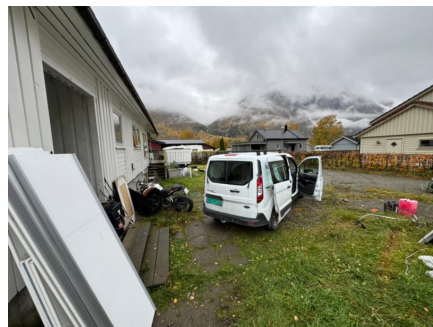
Manglar rekkverk på trapp til inngangsdør-
