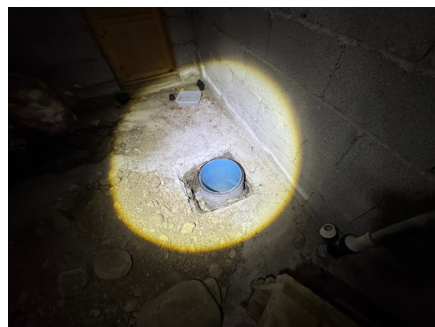
Synkebrønn i kjellar er uten vatn. Laga til for å tappe vatn ved høg grunnvatn til tider.
