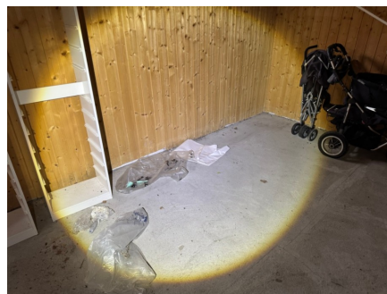
Kledningen på vegg i kjellar er isolert med isopor. Dette må sanerast da dette er brannfarleg materiale.
