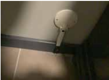
Lekkasjedeteksjon på gulv under utslagsvask på teknisk rom.
