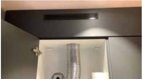
Det er viktig å rengjøre/bytte filter i avtrekksvifte ihht leverandørens anvisning.
