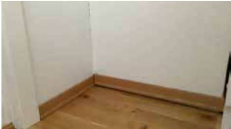
Fotlist på pipe kan flyttes ned til parkett. (Normal setning av bygget)
