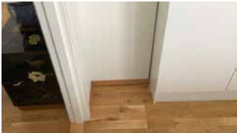
PS! Det er ikke registrert feieluke i etasjen. Kan være skjult med garderobe. I så fall, må skapet fjernes/flyttes. Det er krav om min 30 cm avstand fra feieluke og til brennbart materiale.
