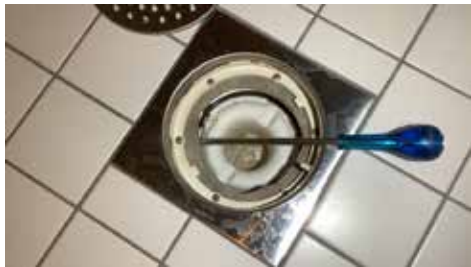
Det er registrert membran som er riktig plassert under klem-ring i sluk.
