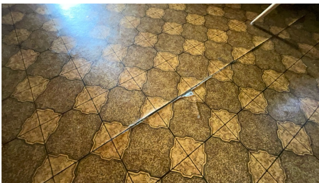
Skade i gulvbelegg
