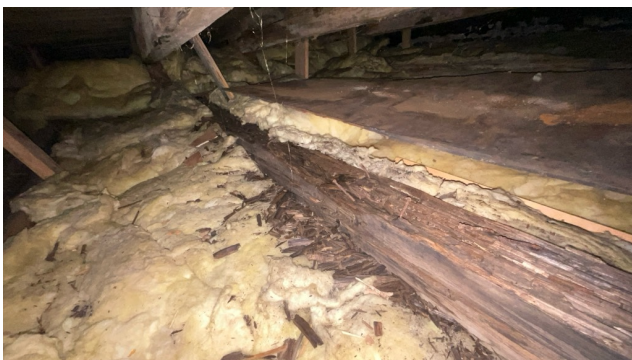
Råte i takkonstruksjonen
