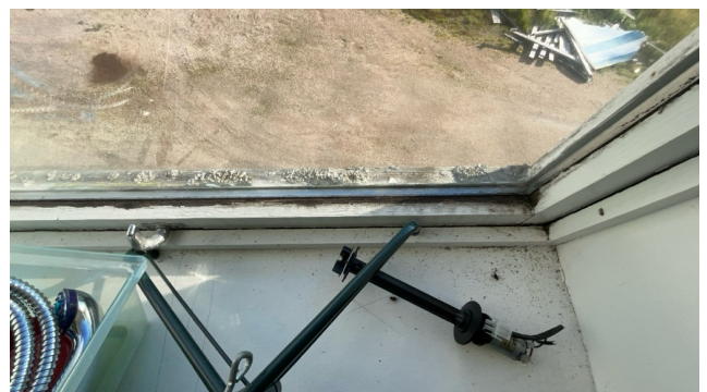
Råte i trevindu
