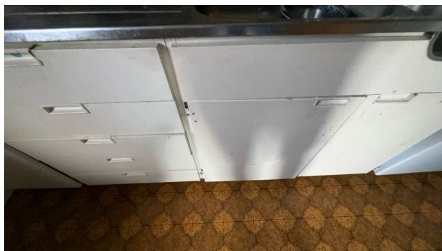
Skade på kjøkkenfront
