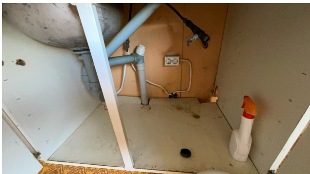
Fuktskade i kjøkkenskap under vask.
