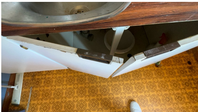
Skader på kjøkkenfronter
