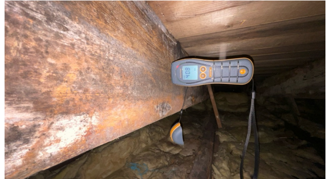
Fuktmåling med forhøyede verdier
