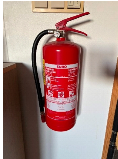
Håndslukker montert i lokalene
