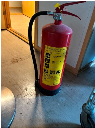
Håndslukker montert i lokalene
