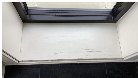
Slitasje i utforinger.
