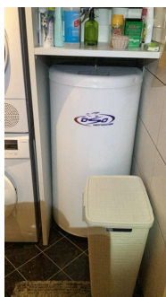
Varmtvannsbereder på bad/vaskerom.
