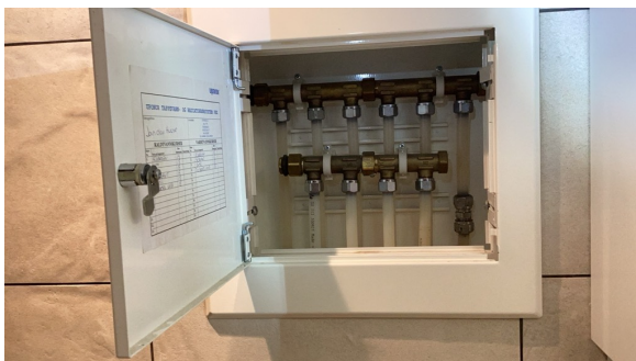
Fordelersskap på bad.
