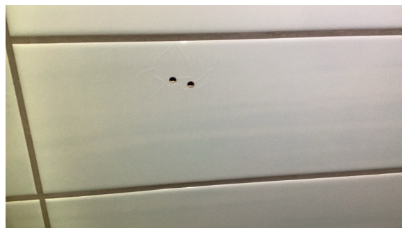
Hull i vegger etter tidligere installasjoner.
