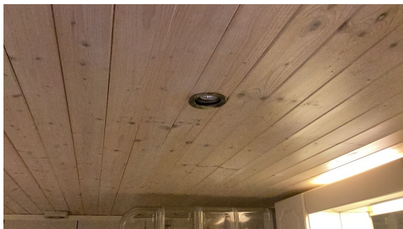
Spotter på bad i 1. etasje virker ikke.
