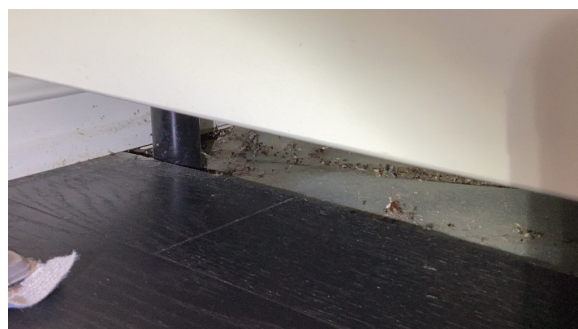
Observert døde maur under kjøkkenbenk.
