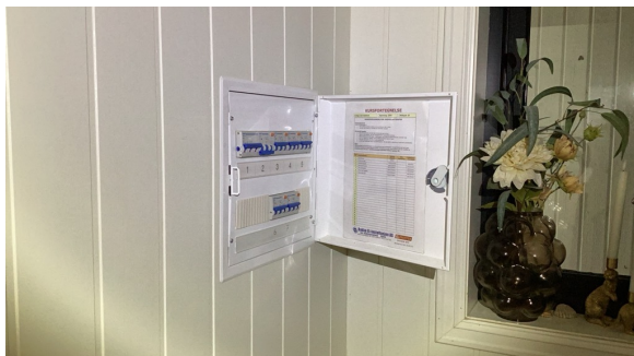
Sikringsskap på soverom.
