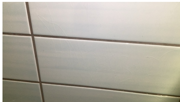
Riss i fliser flere steder.
