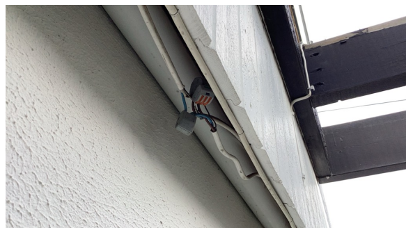
Ufagmessig utførelse, løse ledninger og mangler koblingsboks.
