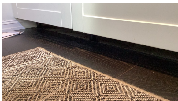
Mangler sokkel på kjøkken.
