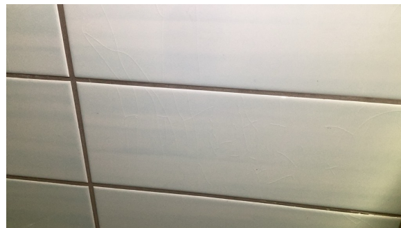
Riss i fliser flere steder.
