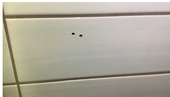
Hull i vegger etter tidligere installasjoner.
