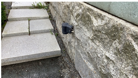
Løse utvendige lamper.
