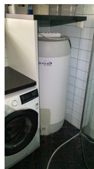
Varmtvannsbereder fra 2006 på bad i 2. etasje.
