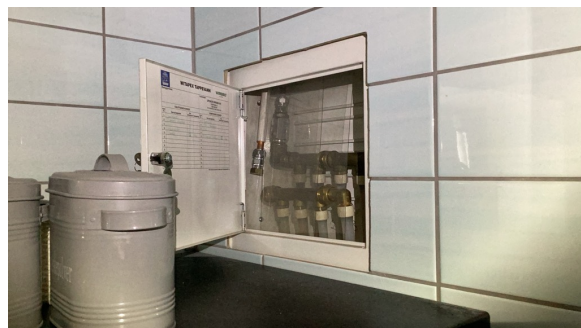
Fordelerskap på bad i 2. etasje.
