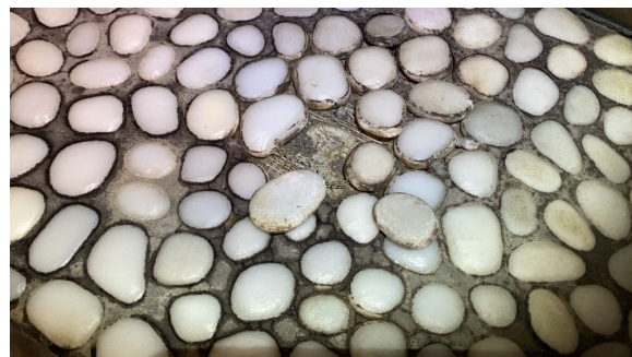
Flere løse steiner på gulv.
