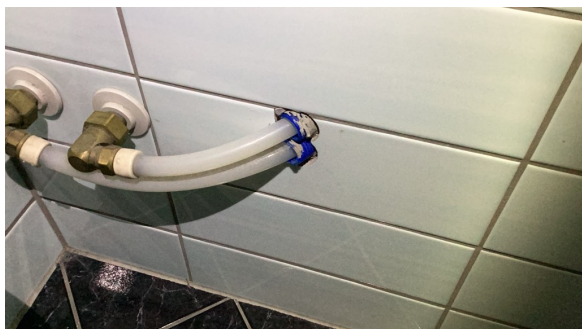
Ufagmessig utførelse ved gjennomføringer.
