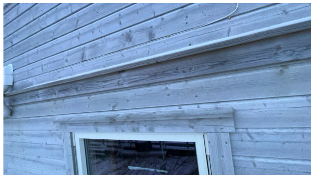
Ufagmessig omramming vindu. Mangler beslag over vannbord
