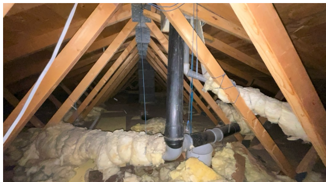
Gjennomføring av lufting i tak. Uisolerte rør og dryppbak under luftehatt.
