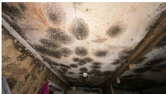
sopp på himlingsplater under bjelkelag
