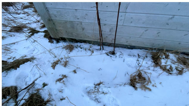
Kledning montert for nærme terreng som øker fare for fuktopptak i kledning
