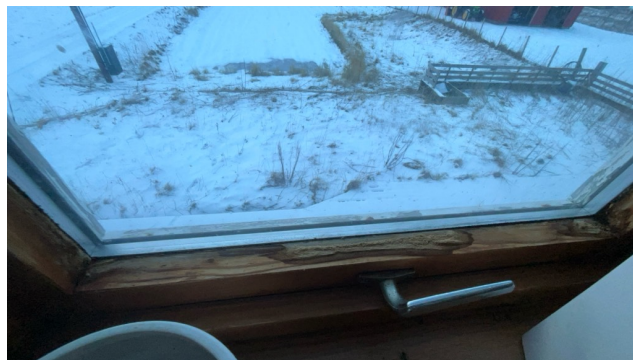
Fuktskader i innvendig vinduskarm
