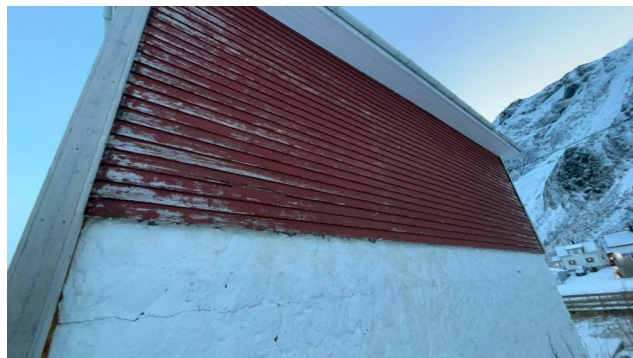
Eldre kledning med spredte råteskader
