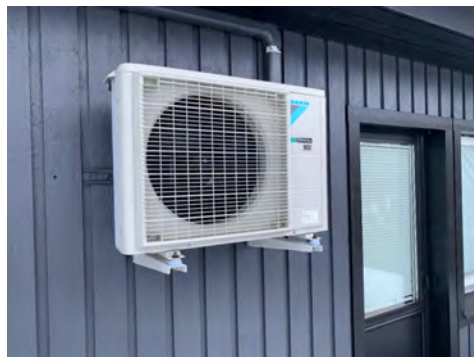
Varmepumpe utvendig del.
