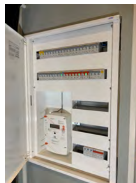
Sikringsskap med automatsikringer, plassert i vaskerom.
