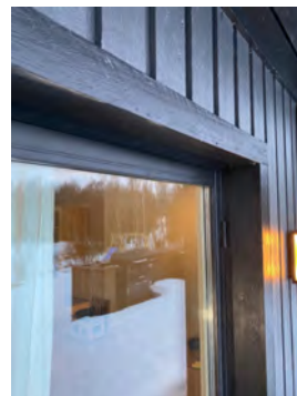
Manglende beslag/vannbrett i øverkant av vinduer.
