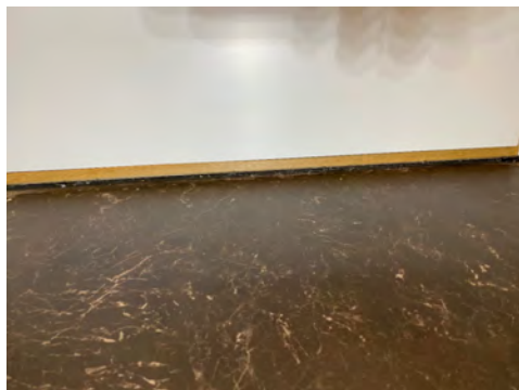
Våtrommet mangler tilluftsventilering, f.eks. spalte i dør.
