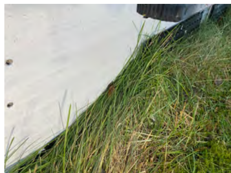
Fuktsikring mot muren må avsluttes over terrenget med klemlist.
