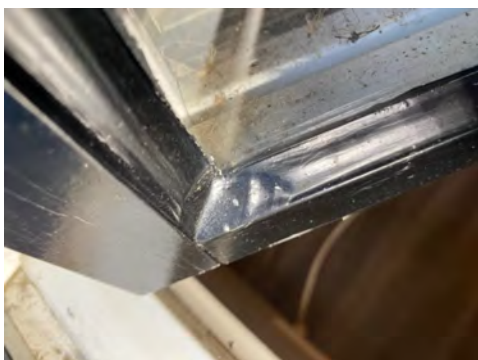
Luftblære i tetting mot glass.
