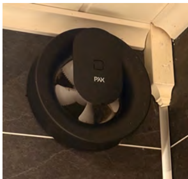
Avtrekk via ventil i vegg.
