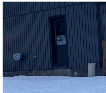
Manglende trapp fra balkongdør.
