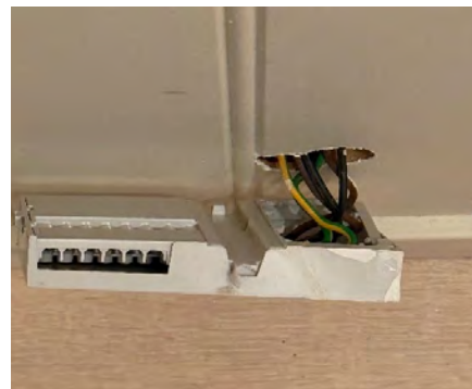
Det er påvist ledninger som ikke er tilstrekkelig festet.
