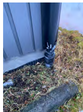
Fuktsikring mot muren mangler klemlist
