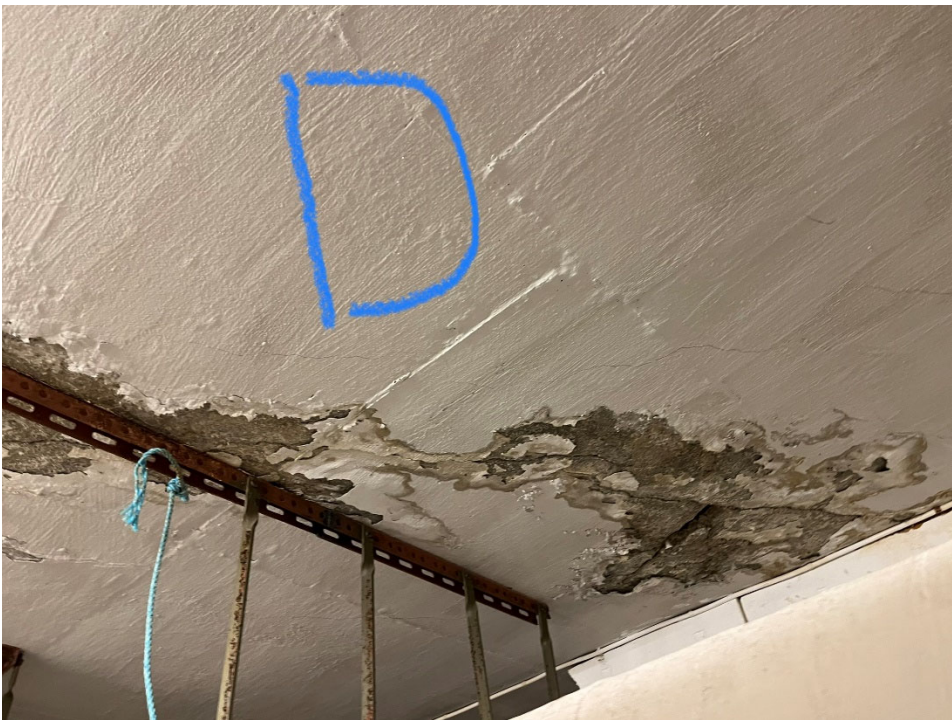
Viser skade på undersiden av betongdekke over basseng fra sluk, se pkt. D
