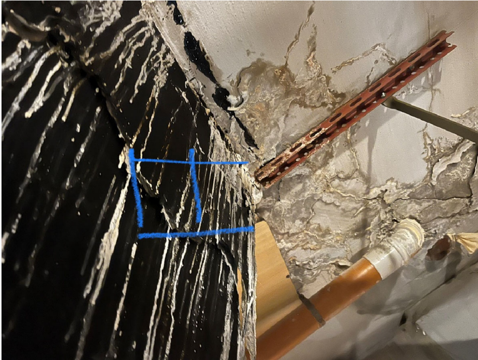
Viser skade på undersiden av dekke over basseng rundt rør/sluk, se pkt. A
