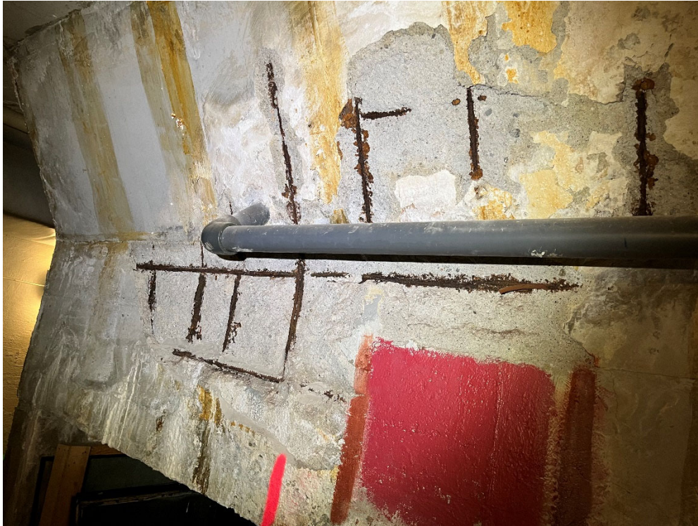
Viser skade på bassengvegg i under etg. se pkt. 1 på plan over
