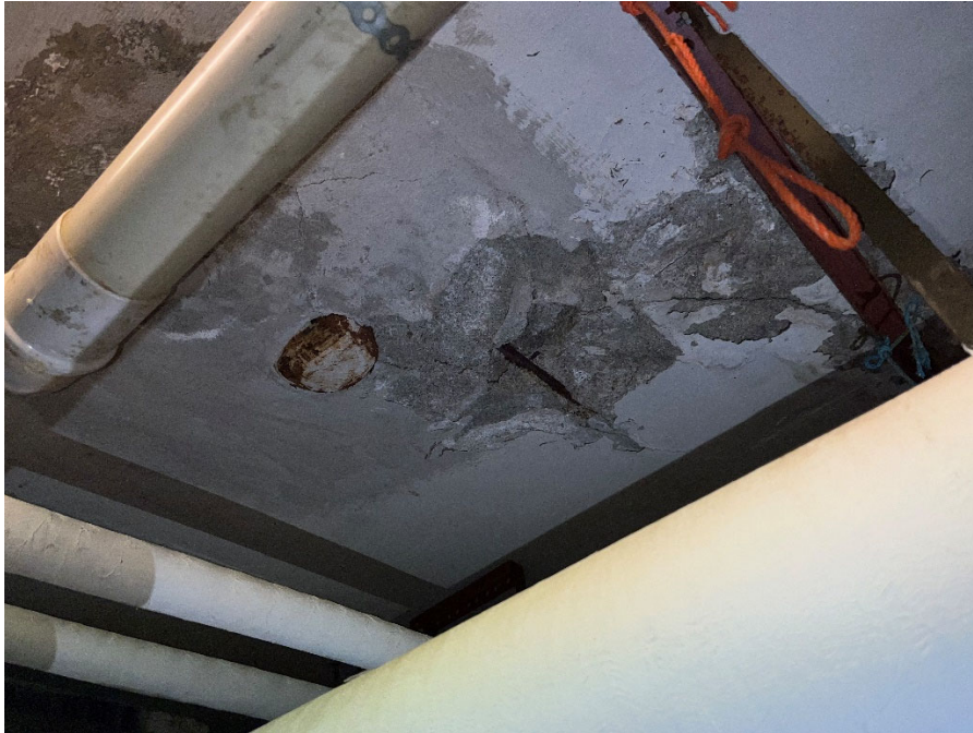
Viser skader i betongdekke pga. innstøpte sluker, ref. til pkt. over A, C, D og E
