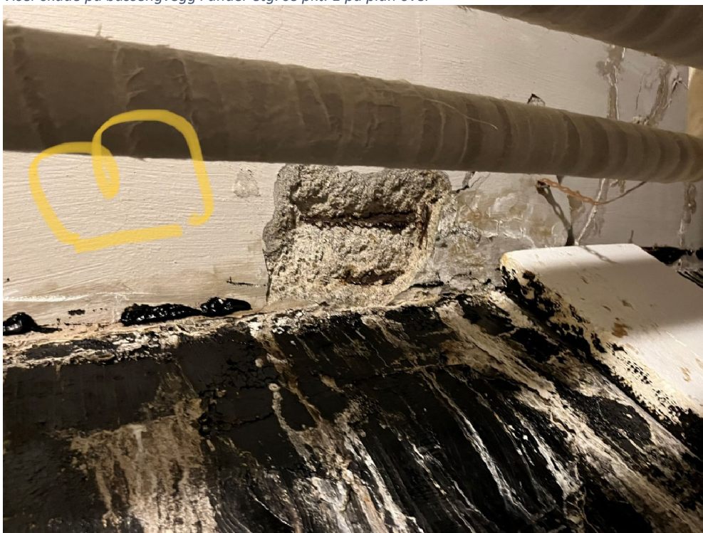
viser skade på betongdekke over basseng, se pkt. B
