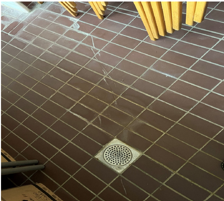
Viser sprekker på oversiden av fliser pga. skader fra innstøpt sluk, bilde over, ref. til pkt. over A, C, D og E
