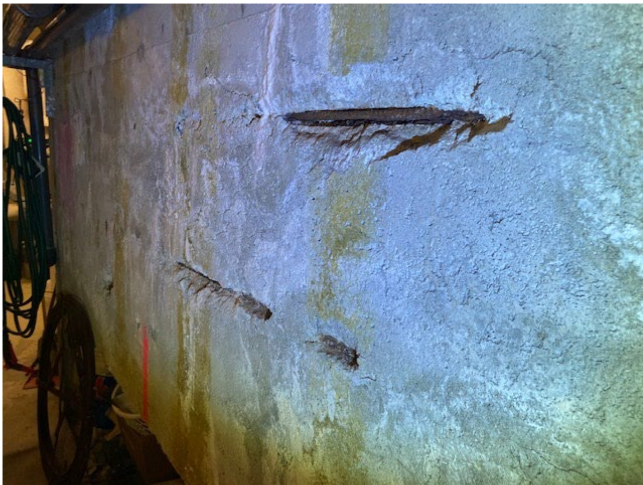
7.20 – Synlig armering på vegger, bassengrom under etg.
