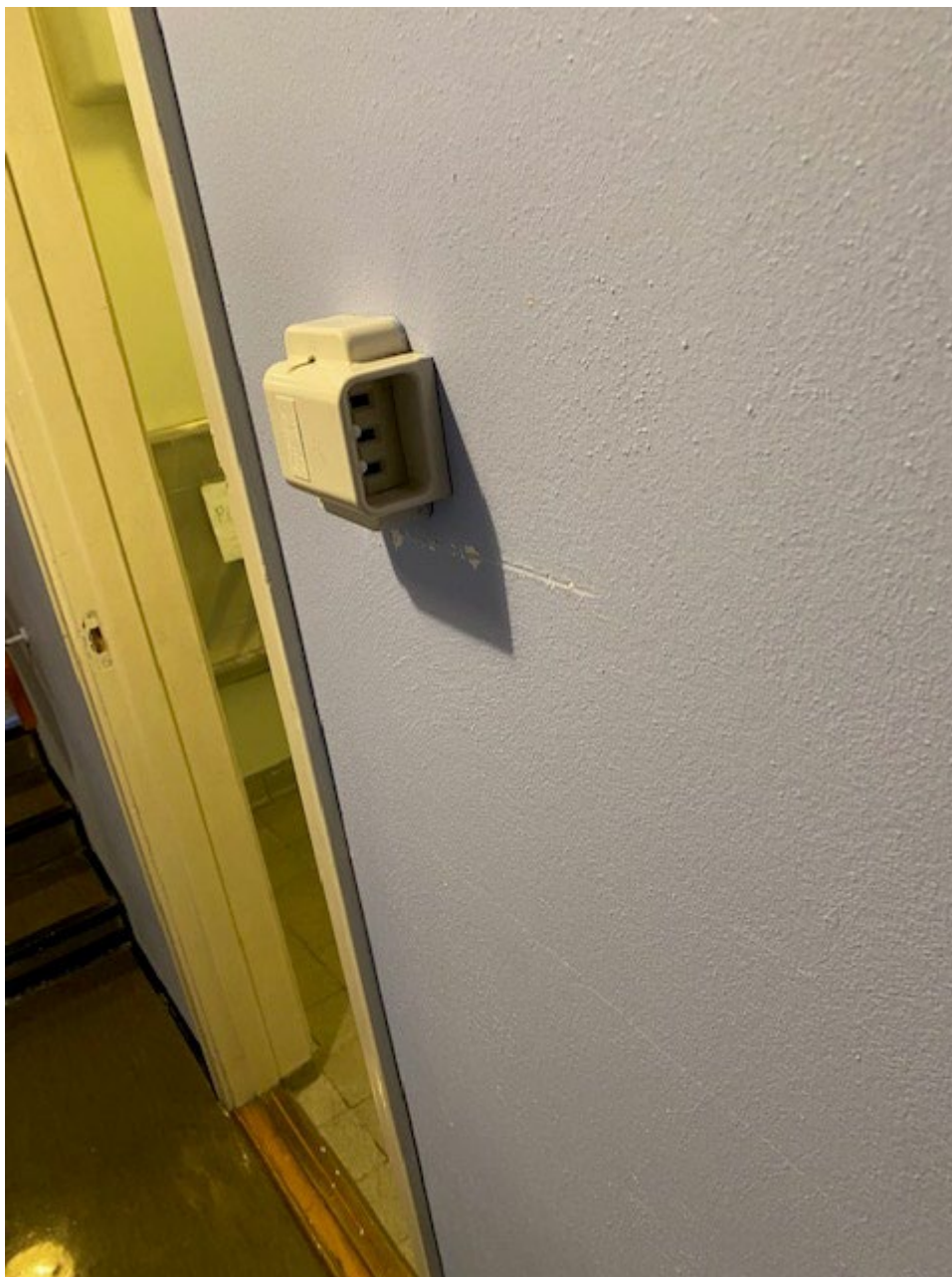
7.33 – Kontakter som er usikret denne står i åpen korridor ved gang. 25 A kurs.
