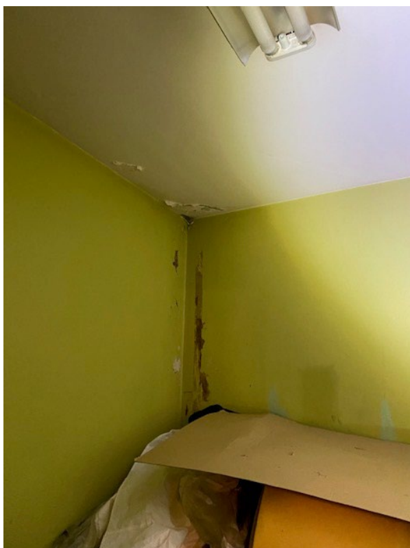
7.9 Innvendig garderobe i gymsal/svømmehall som viser sprekker i tak og vegger.
