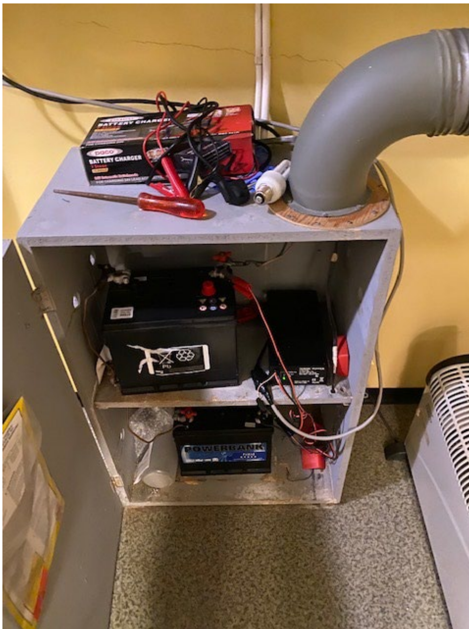
7.22 – Nødstrøm plassert i bomberom.
