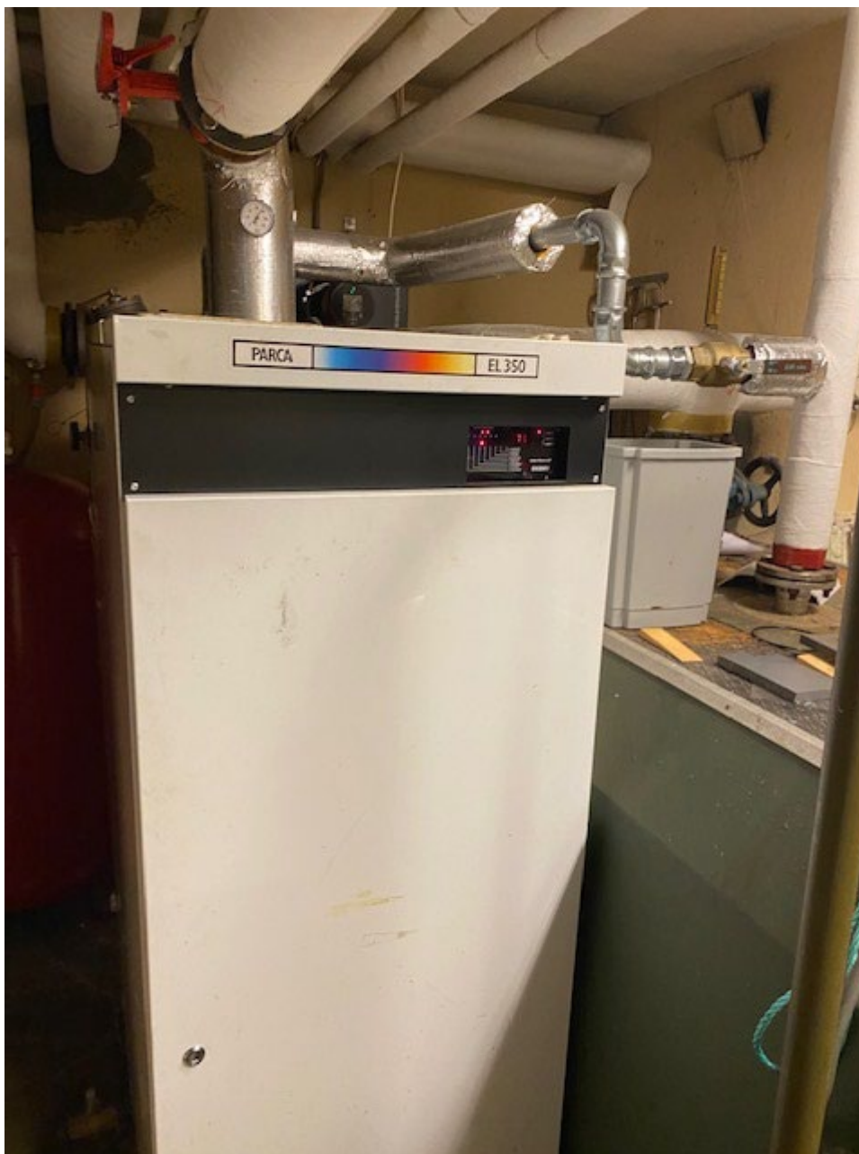
7.34 – El-kjele som er montert som oppvarming av bygget.
