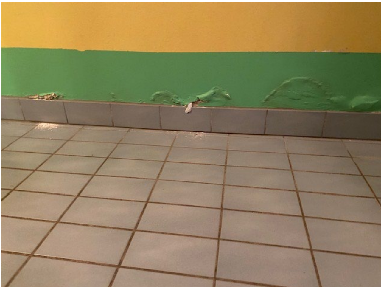
7.11- sprekker og avflassing av maling i garderober gymsal/svømmehall.
