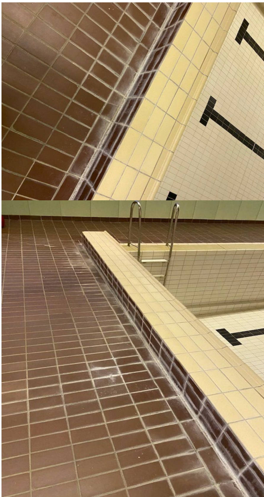
7.12- Fug og fliser i svømmehall.
