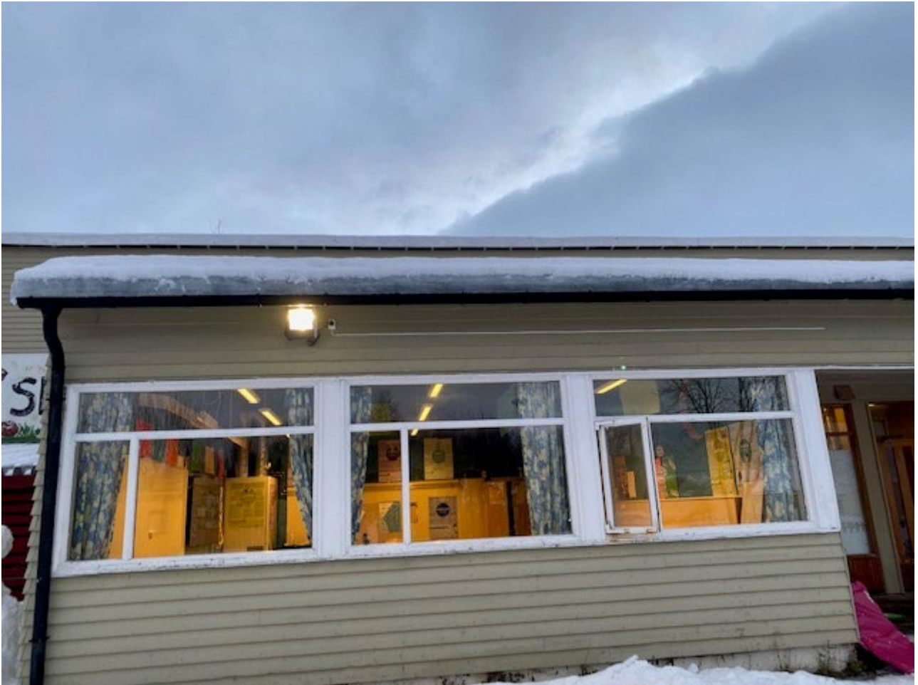
7.3 – Isdannelse i takrenne, samt slitasje på vinduer. Vestside
