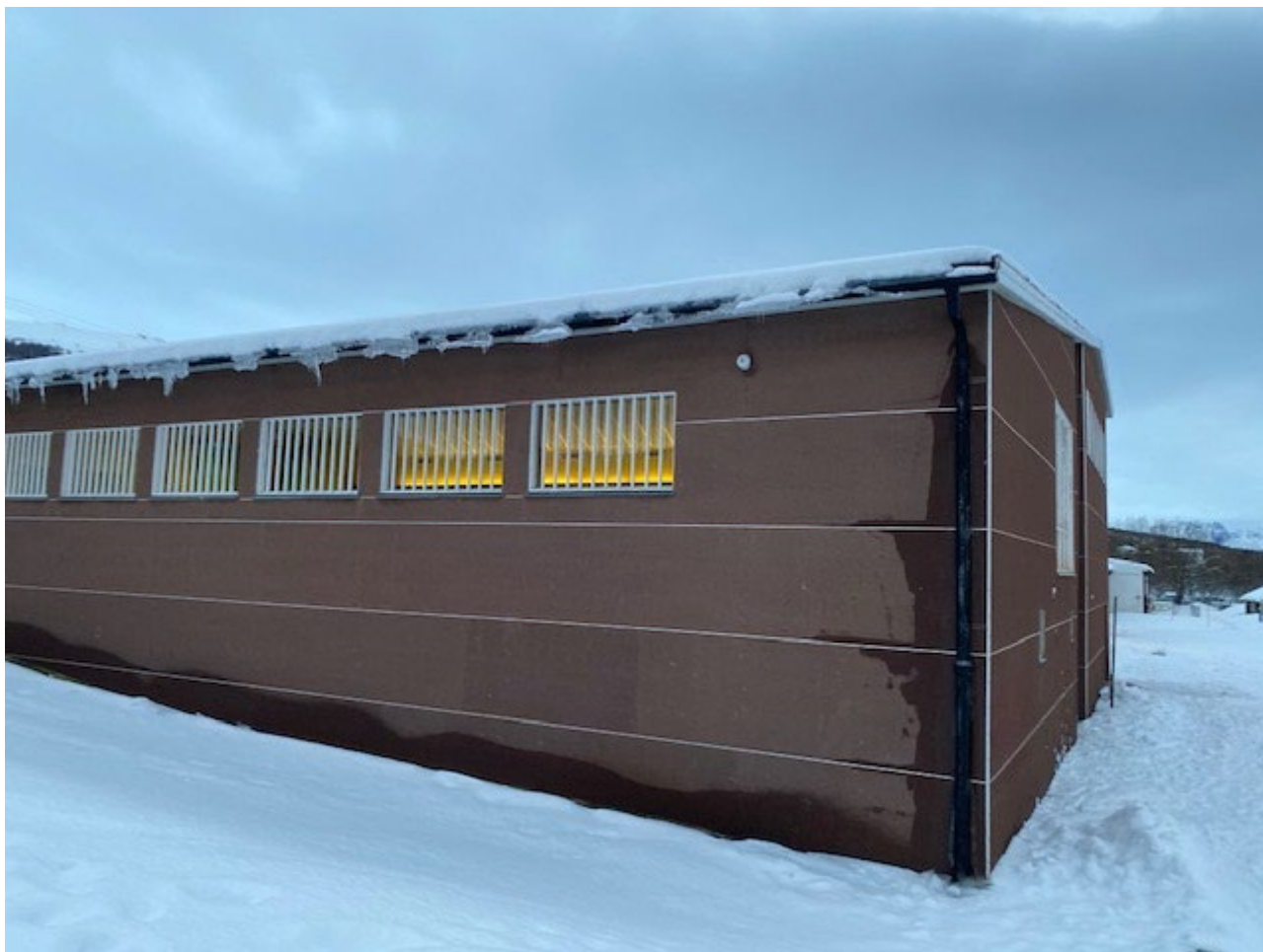
7.5 – Tett tak nedløp, isdannelse i takrenner. Nordside av svømmehall
