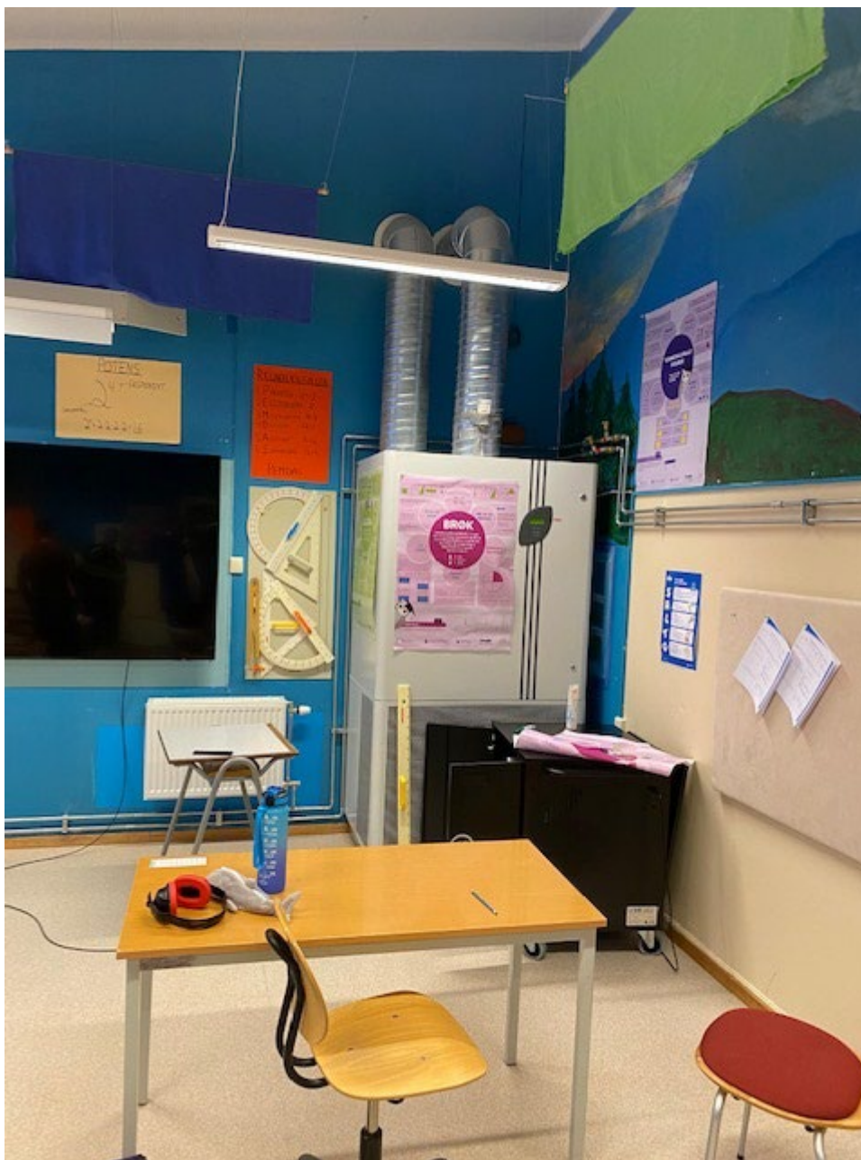
7.31 – Ventilasjonsanlegg som er montert. Optimal drift er opplyst når klasseroms dør er lukket.
