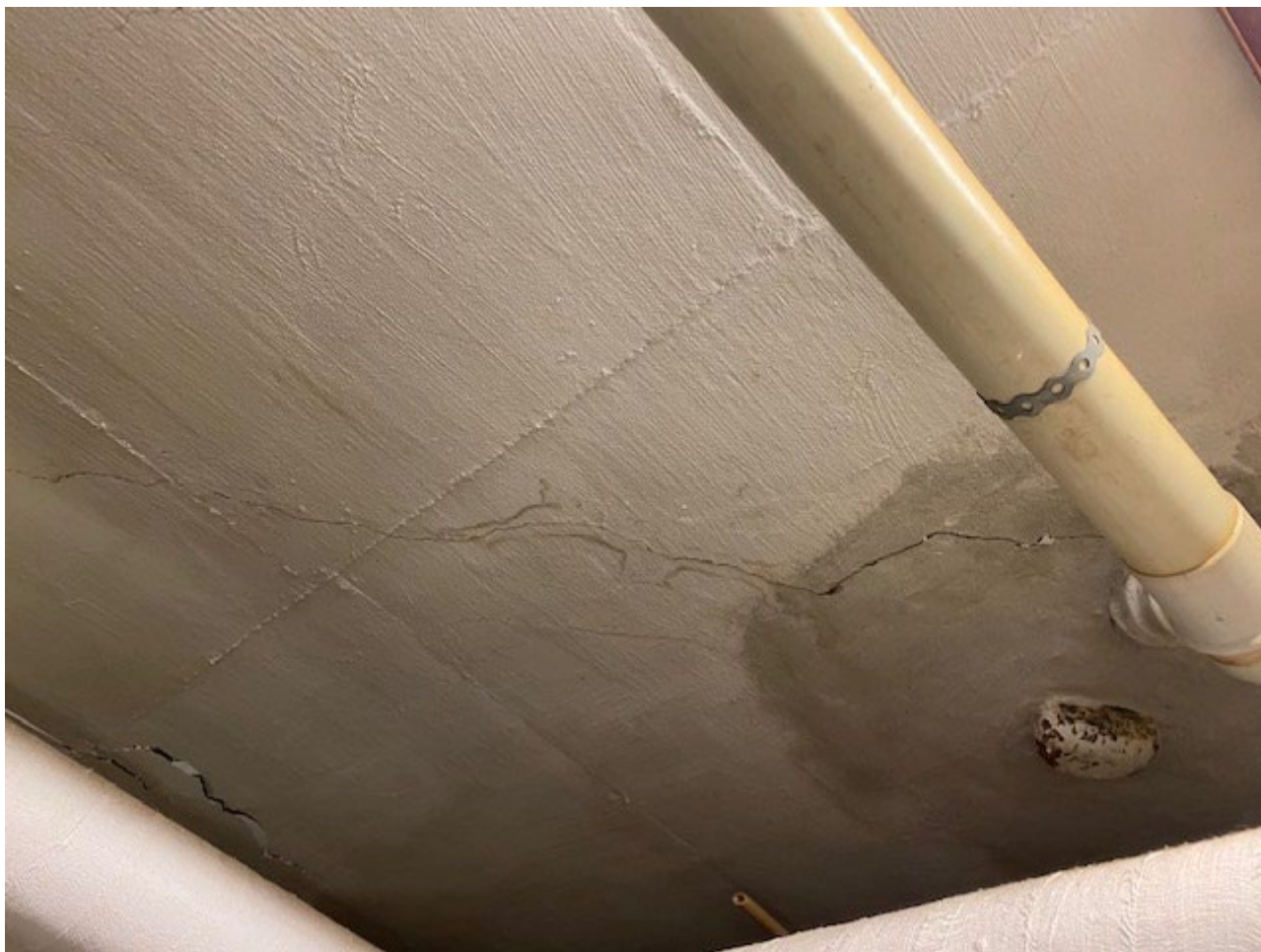
7.21 – Sprekker i tak, lik sprekker i fliser på oversiden av disse punktene.
