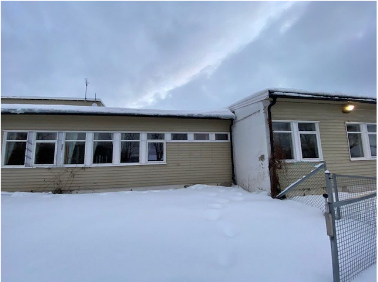
7.8 – Sprekker i betong og isdannelse i takrenner. Mot vest.
