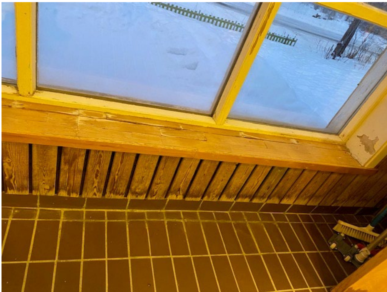
7.18 – Vegg, vindu og foring som er skadet i bassengrom.
