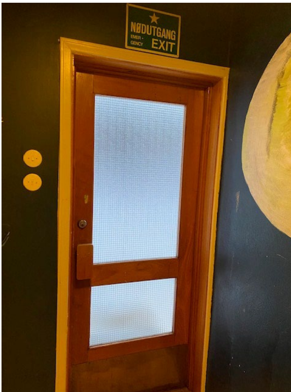
7.24 – Dør som ikke har isolasjonsverdi. Nødutgang.
