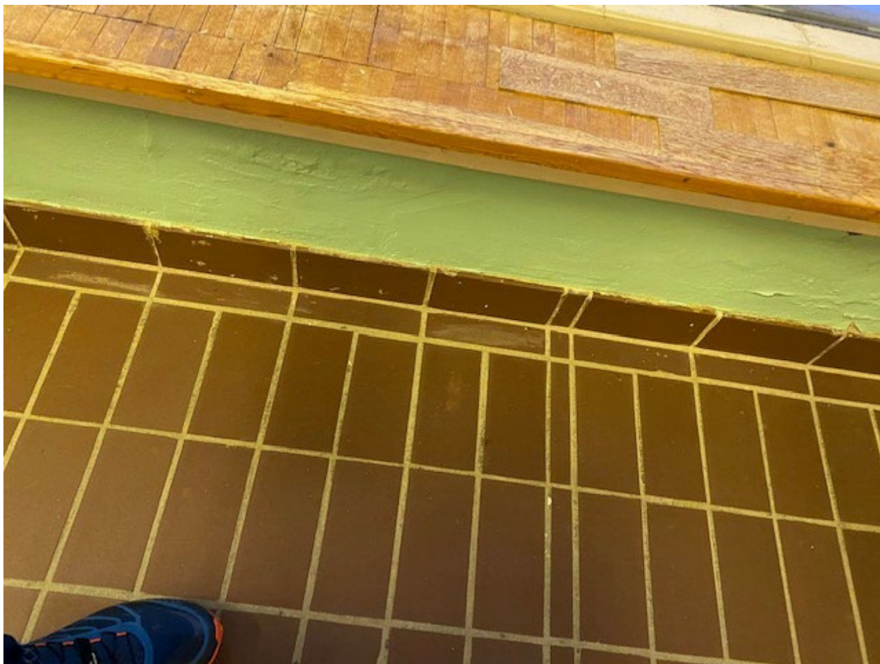
7.17- Vegg som er skadet. Bassengrom.
