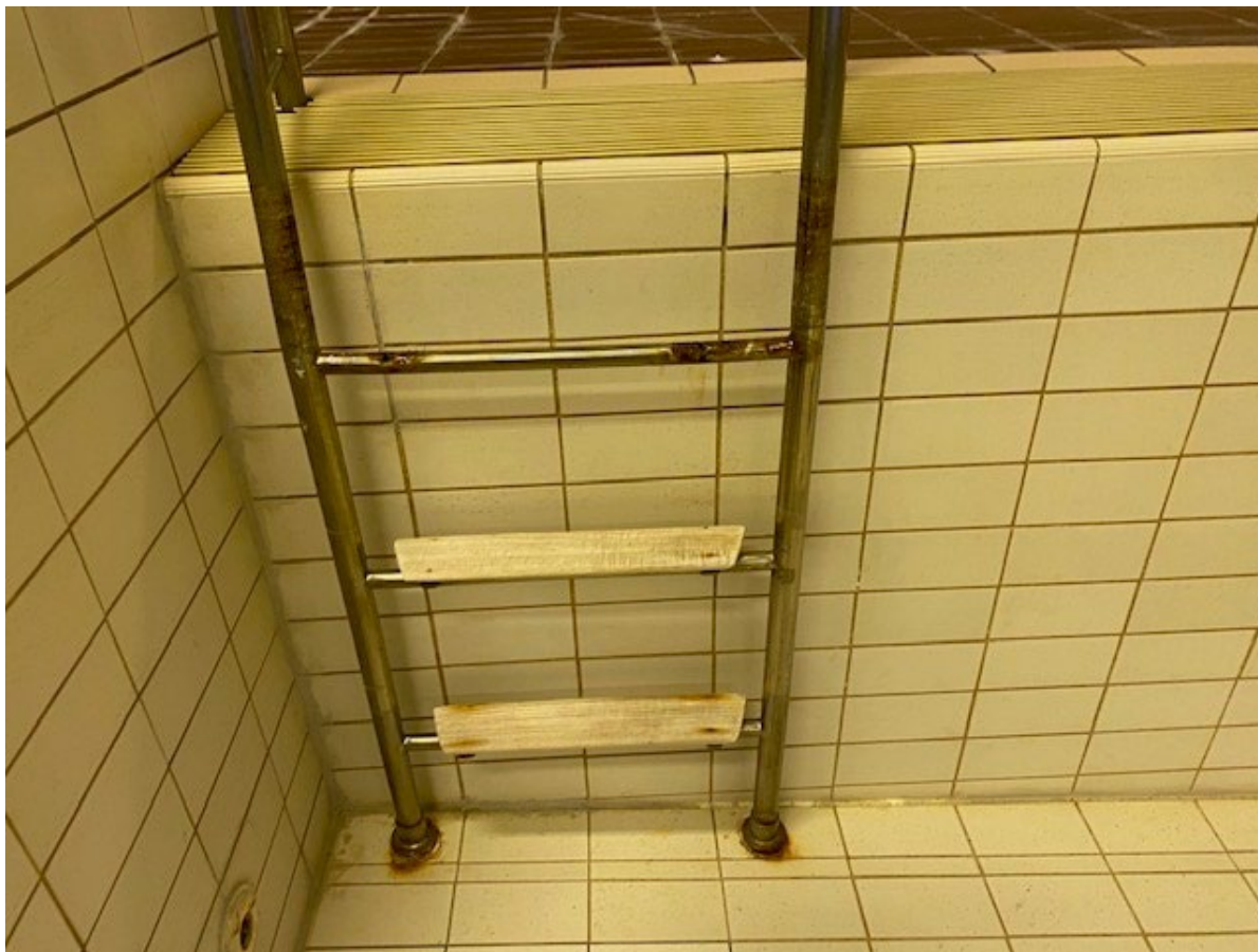
7.15 – Stige til basseng, rustet og mangler trinn.
