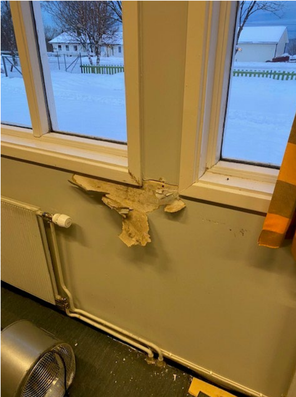
7.25 – Vegg plater som går i oppløsning pga lekkasjer fra vinduer. Mot vest.
