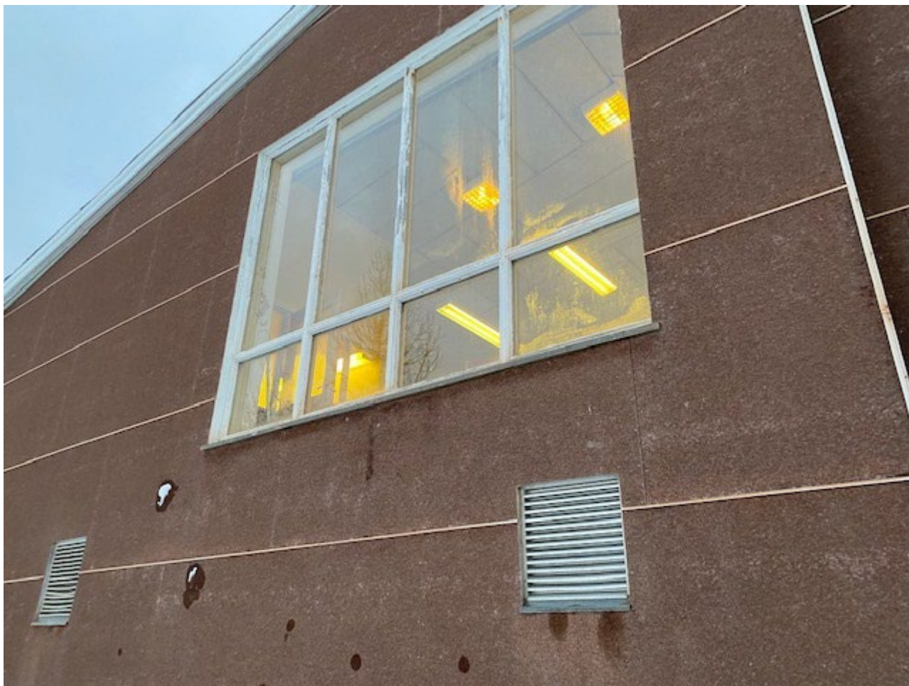
7.4 – Slitasje på vinduer mot vest. Gymsal.
