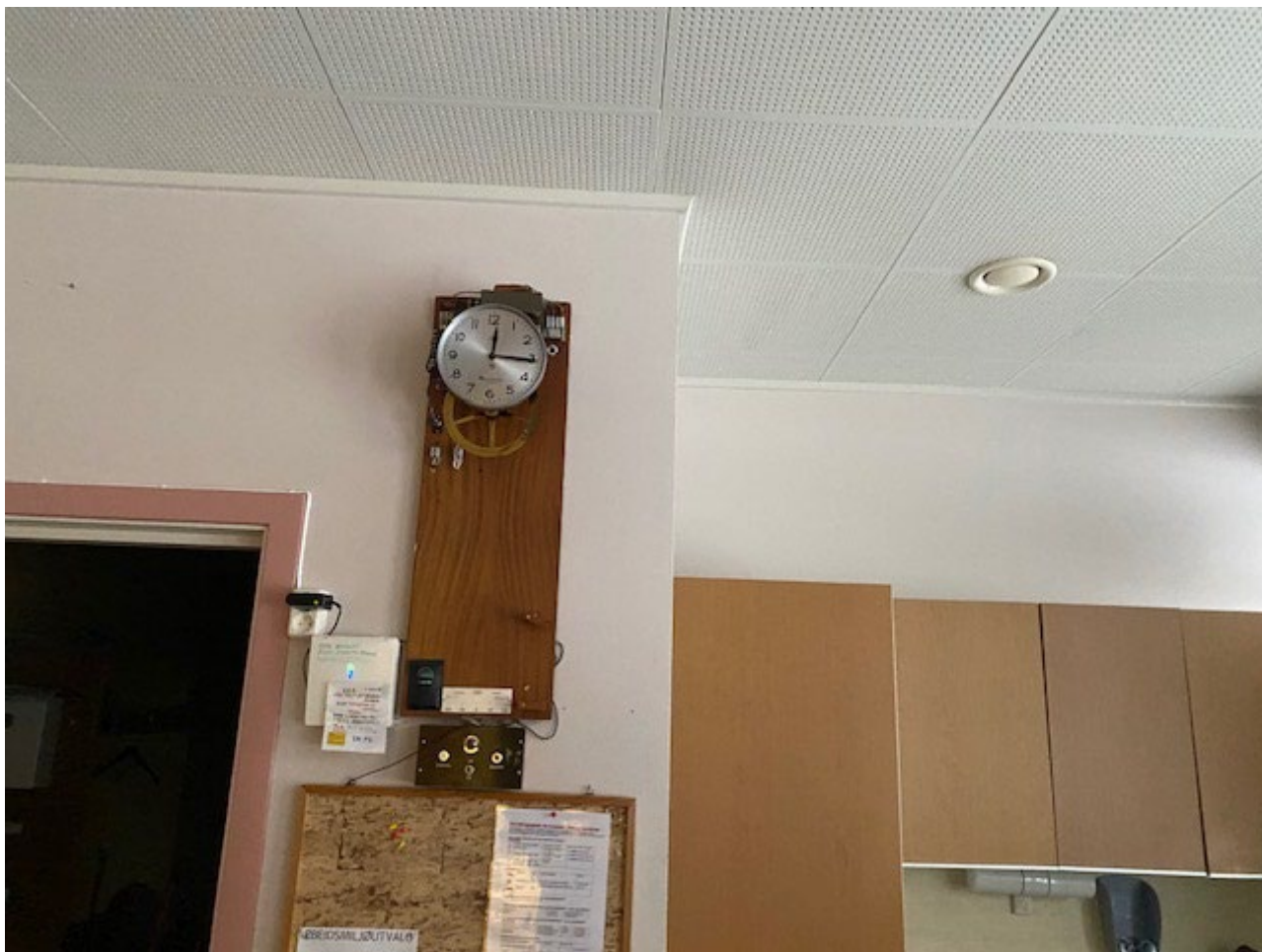
7.29 – Skolens brannvarslingsanlegg. Denne er montert i delen av bygget som er avstengt pga mugg.
