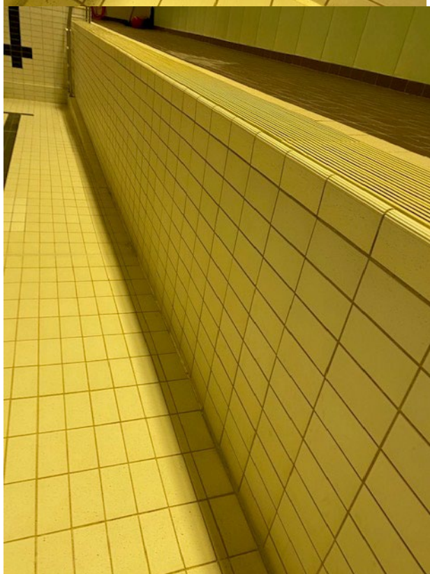
7.14 – Sprekker i fug, bassengfliser som har lite fugemasse.
