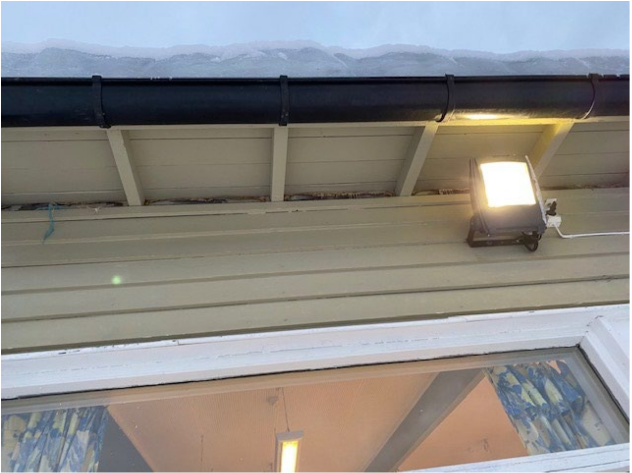
7.2 – Isdannelse takrenner vestside.
