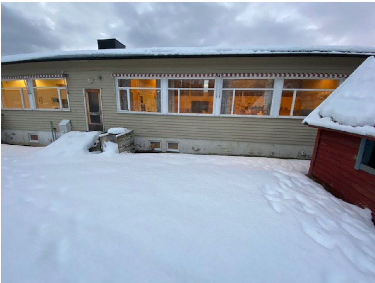
7.6 – Isdannelse i takrenner, sprekker og maling samt vindus slitasje. Østside av skole. Dør som brukes som nødutgang. Trapp er defekt samt mangler sikring.
