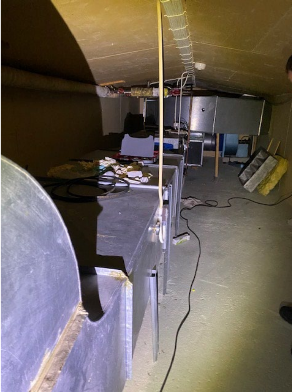
7.35 – Ventilasjonsrom i skolebygget, er ikke i drift.
