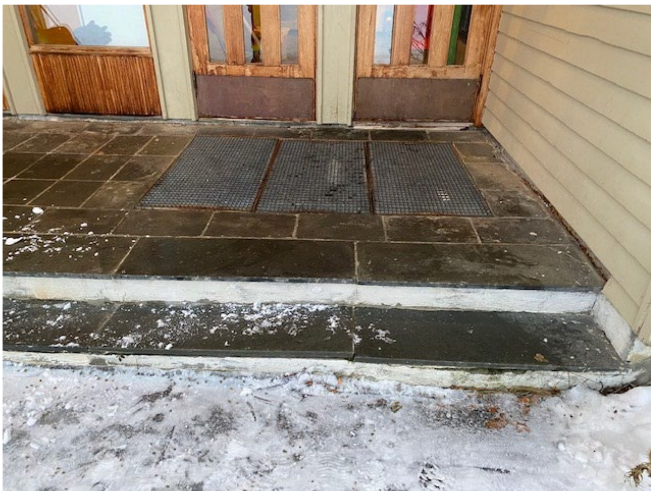
7.1 - Dårlig betong, løse heller samt manglende universell utforming. Hoved inngang.
