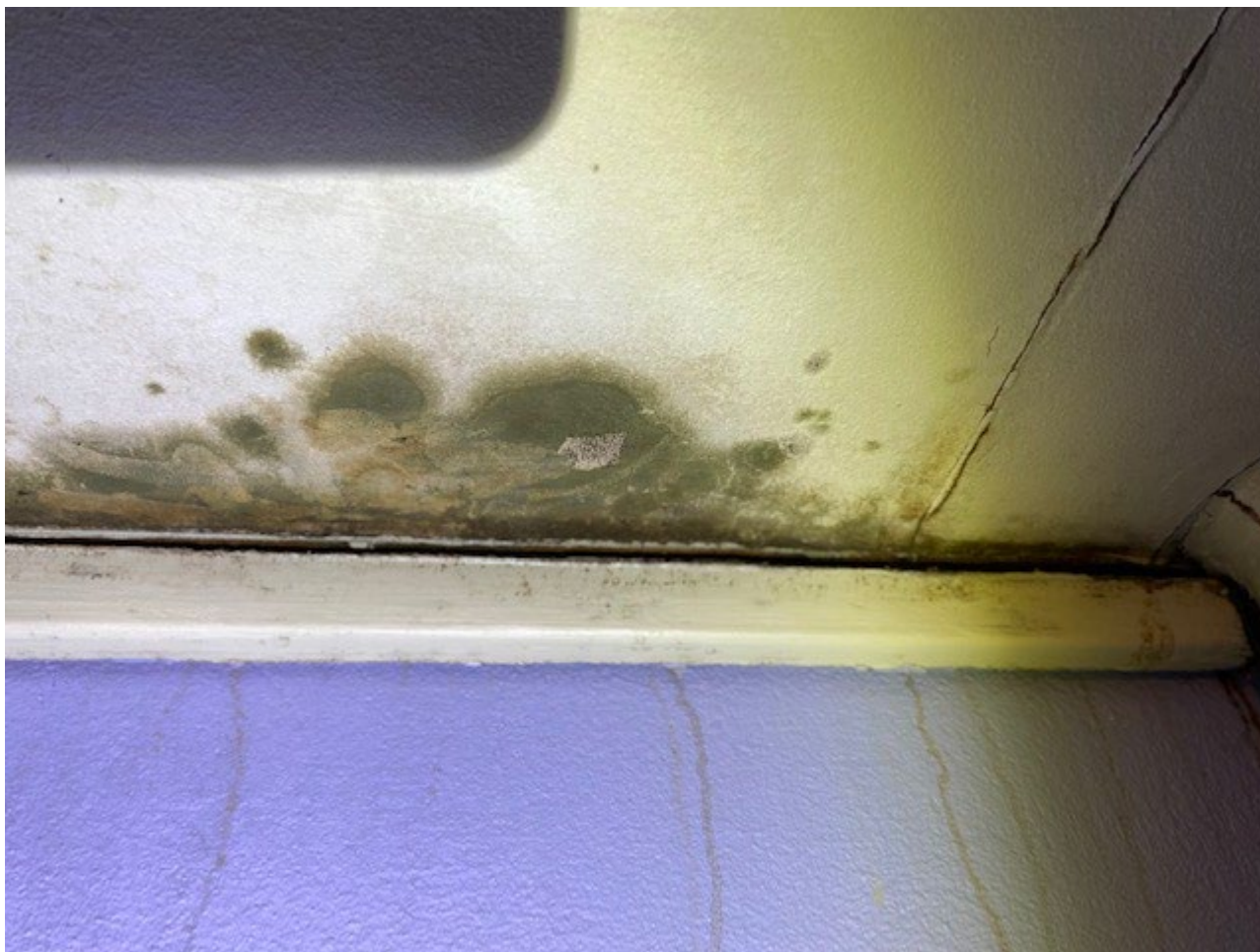
7.28 – Muggsopp i tak bøttekott.
