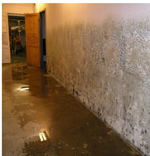
Muggsoppvekst som følge av vannskade
