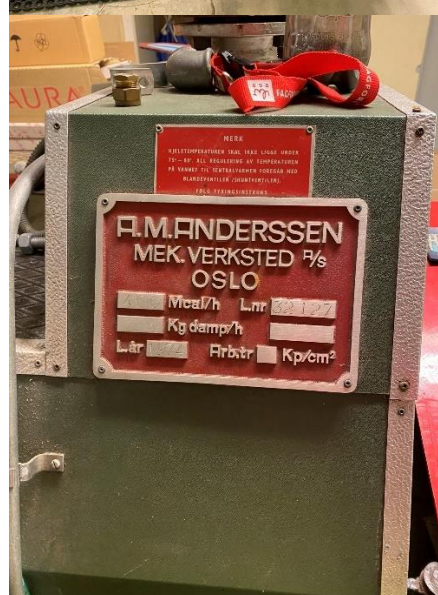
Plassering: Vent.- og fyrrom Materialtype: Oljefyrkjel
