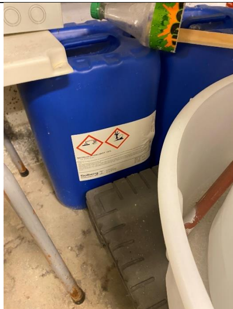
Plassering: Renserom under svømmebasseng Observasjon: Natriumhypokloritt
