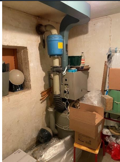
Plassering: Tilfluktsrom, gamle skolebygningen Materialtype: Ventilasjonsaggregat Verdi/antall: 1 stk.
