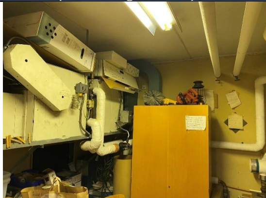
Plassering: Vent- og fyrrom, gamle skolebygningen Materialtype: Ventilasjonsaggregat Verdi/antall: 1 stk.
