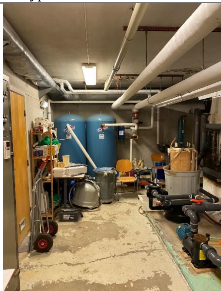
Plassering: Renserom EE-type: Varmtvannsbereidere
