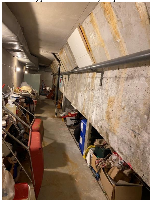
Plassering: Renserom under svømmebasseng Materialtype: Harde isolasjonsplater
