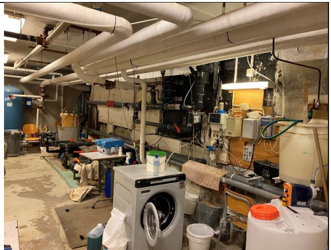
Plassering: Renserom under svømmebasseng Materialtype: Harde isolasjonsplater
