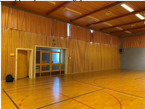
Plassering: Gymsal EE-type: Lysarmatur og lysstoffrør
