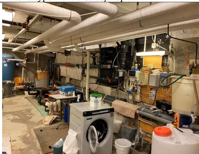
Plassering: Renserom under svømmebasseng Materialtype: Harde isolasjonsplater
