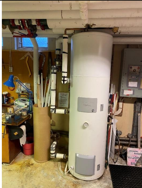
Plassering: Fyrrom EE-type: Varmtvannsbereider
