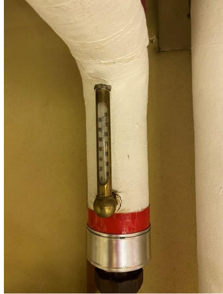
Plassering: Fyr- og vent.rom Materialtype: Termometer
