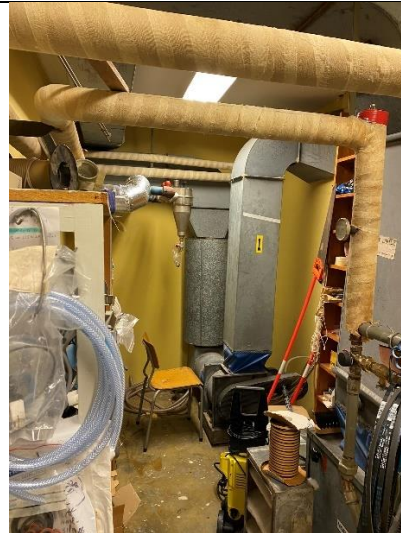
Plassering: Ventilasjonsrom ved renserom under svømmehall Materialtype: Ventilasjonsaggregat Verdi/antall: 1 stk.
