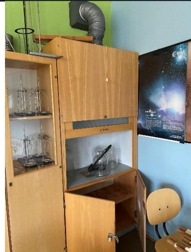
Plassering: Gr.rom ved naturfagsrom Materialtype: Avtrekksskap Verdi/antall: 1 stk.
