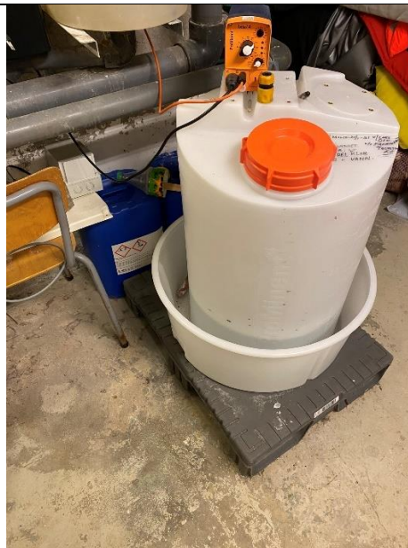
Plassering: Renserom, under svømmebasseng Observasjon: Natriumhypokloritt
