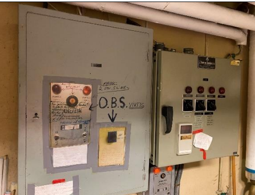
Plassering: Fyrrom ved eldre undervisningsfløy EE-type: Elskap
