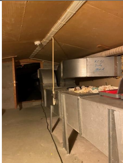
Plassering: Ventilasjonsrom nye undervisningsfløy Materialtype: Ventilasjonsaggregat Verdi/antall: 1 stk.
