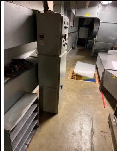
Plassering: Ventilasjonsrom ved gymsal Materialtype: Ventilasjonsaggregat Verdi/antall: 2 stk.
