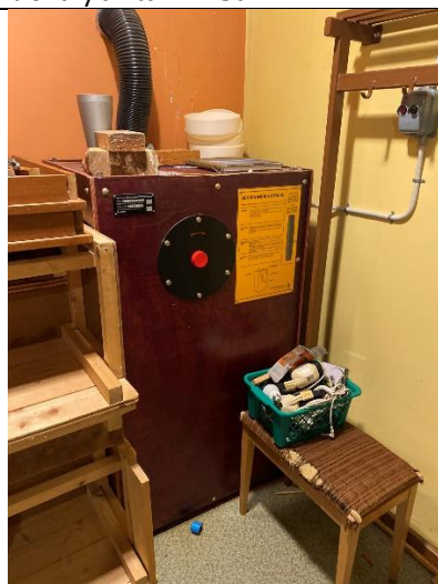
Plassering: Tilfluktsrom, gymsal Materialtype: Ventilasjonsaggregat Verdi/antall: 1 stk.
