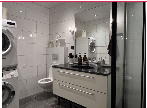
Helfiiset og moderne baderom med varmekabler i gulv.
