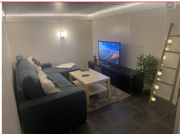
Rom i kjeller brukt som Tv-stue. NB: Ikke godkjent for varig opphold.
