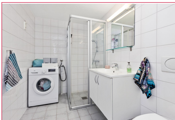
Varmekabler på bad.
