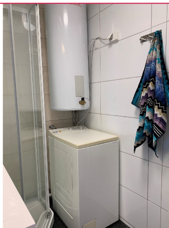
Det er toppmatet vaskemaskin på badet.
