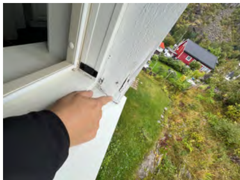
Treverk er montert helt ned mot beslag med påfølgende stedvis råde.
