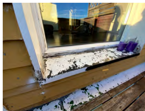
Vannbrettbeslag er utett og vindu er montert innenfor veggpapp/inni klimaskille
