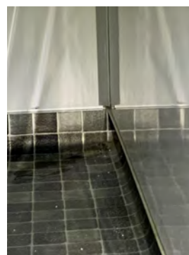
Ikke fuge mellom list og baderomsplater. Utett hjørnelist
