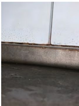
Fuktpåvirket skjøt. Og baderomsplater nært gulv.
