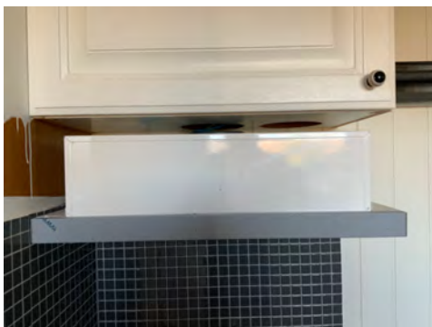
Ikke koblet til ventilasjonsrør
