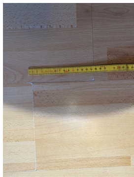
Laminatgulvet på stuen er ikke montert i henhold til leggeanvisning, da skjøtene er plassert for nær hverandre.
