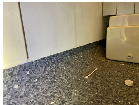
Manglende alulist/tetting i nedkant av plater.
