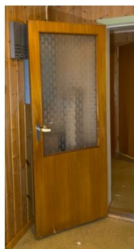
Enkelte dører har skader i overflater.
