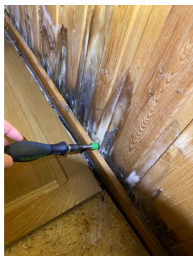
Det er stedvis påvist synlige råteskader/svertesopp på overflater.
