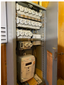
Sikringsskap med skrusikringer, plassert i gangen i kjeller.
