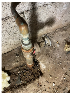
Stoppekrane er ikke funksjonstestet grunnet alder.
