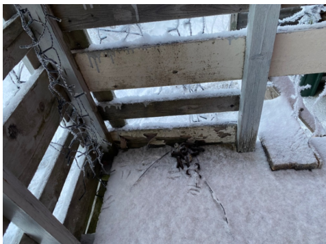
Råteskader i rekkverk.
