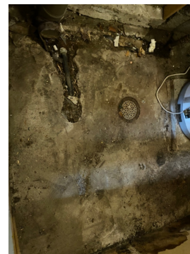
Fuktskader i vegg/fukt mot betonggulv.
