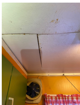
Svellinger/fuktskader i takplater.
