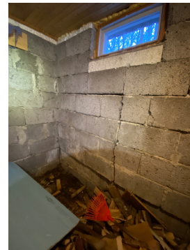
Det er registrert setningsskader og jordtrykk. Store riss/sprekker.
