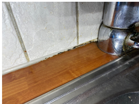
Svertesopp mellom benkeplate og vegg
