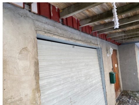
Sprekk i betong over garasjeport.
