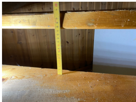
Åpning mellom trinn.
