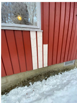
Enkelte kledningsbord mangler overflatebehandling
