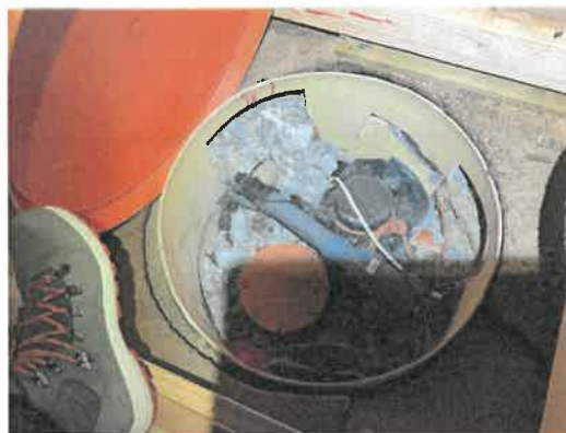
Tank som er plassert under gulv i mellombygg
