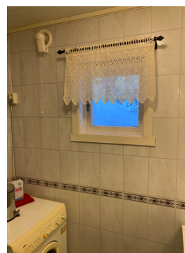
Vindu og dør er plassert i våtsonen.
