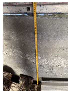
Ved høyde på over 0,5 meter over bakkenivå, skal det være montert rekkverk for å kunne forhindre fallulykker.
