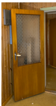
Enkelte dører har skader i overflater.
