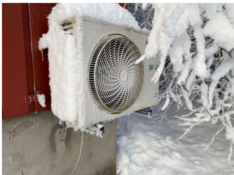
Varmepumpe utvendig del.
