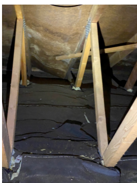
Suplater er stedvis løsnet og har stedvis svertesopp.
