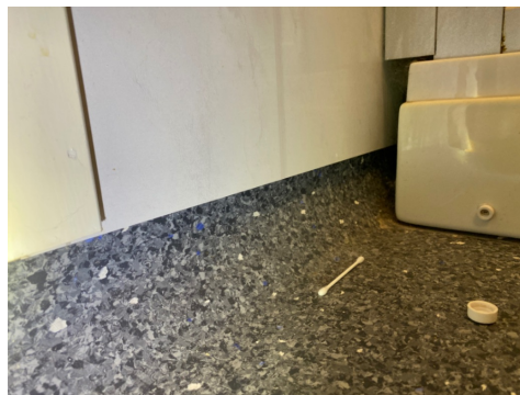
Manglende alulist/tetting i nedkant av plater.
