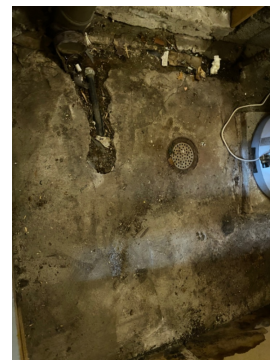
Fuktskader i vegg/fukt mot betonggulv.
