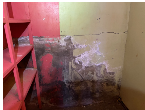
Saltutslag/fukt mot vegg/gulv.
