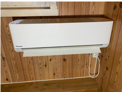
Varmepumpe innvendig del.
