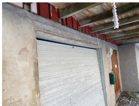
Sprekk i betong over garasjeport.
