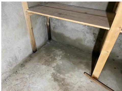
Fukt mot vegg/gulv.
