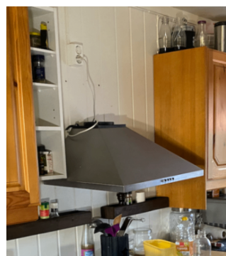
Ventilator mangler kanal for avtrekk
