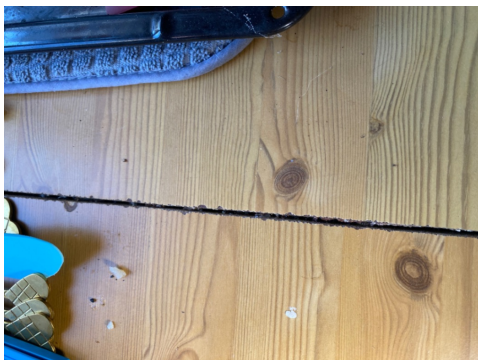
Slitasje, manglende tetting av benkeplate.
