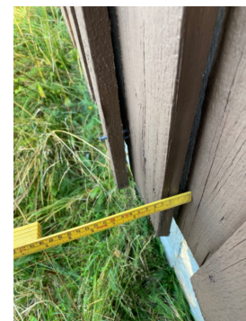
Glippe mellom bord, værslitt kledning.
