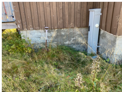
Det er ikke etablert drenering rundt bygningen.
