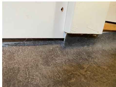
Gulvbelegg er ikke fagmessig utført.
