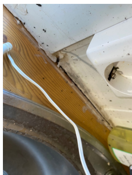
Manglende fugging mellom benk/vegg, tegn til svertesopp.
