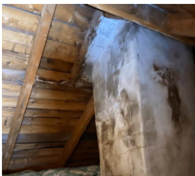
Råteskader/fukt mot taktro.
