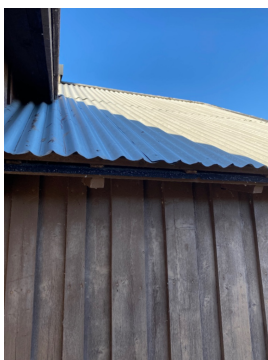
Takrenner, beslag og nedløpsrør mangler.
