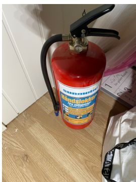
Brannslukkerapparat er eldre enn 10 år.
