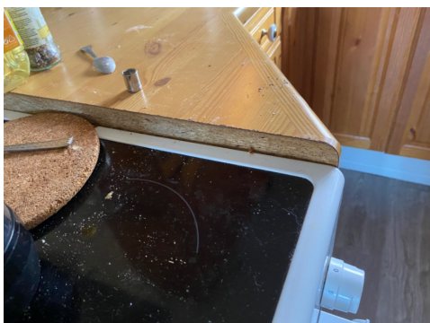
Manglende laminering av benkeplate.
