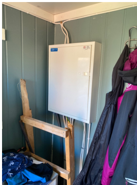
PR-kabler under sikringsskap ligger utsatt til og er ikke beskyttet mot mekaniske påkjenninger.
