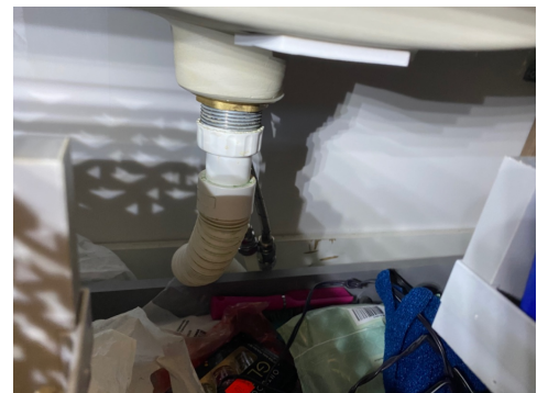
Manglende vannlås, bad.
